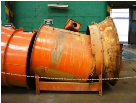
Ventilador afectado por la corrosión
