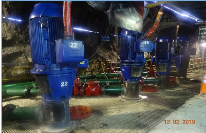
Estación principal de bombeo con cuatro bombas estacionarias instaladas en un espacio amplio.
