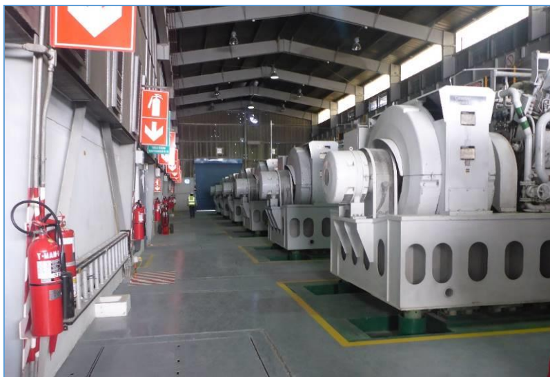
Casa de Fuerza con los Generadores eléctricos en espacio amplio y delimitados. Fuente: Osinergmin
