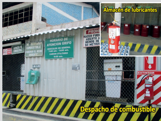
Extintores portátiles tipo PQS ubicados en las áreas críticas; almacén de lubricantes, tanques estacionarios de combustible y estación de despacho de combustible.
