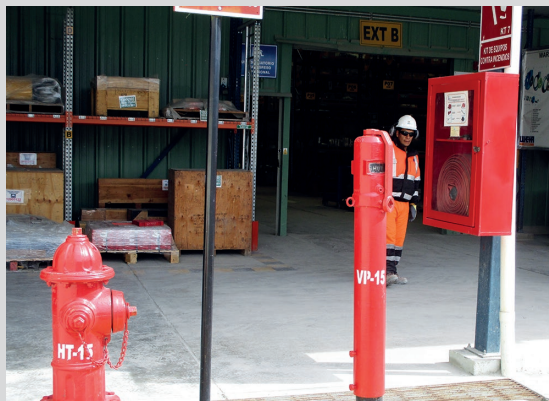
Almacén central implementado con un hidrante identificado mediante código y un gabinete con manguera.
