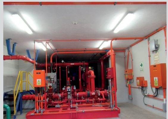
Vista de la sala de bombas de lucha contra incendios (LCI), estructura de albañilería confinada con vigas y columnas de concreto armado y losa de concreto con revestimiento de ladrillo.
