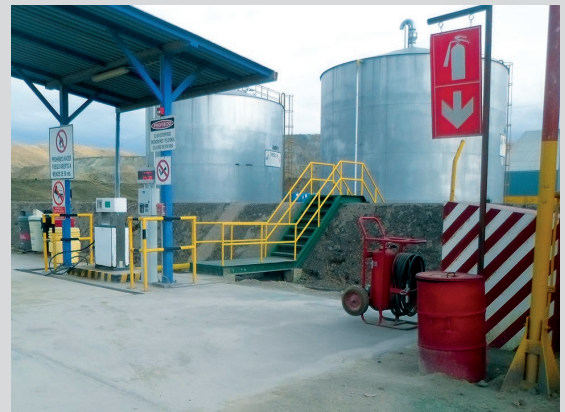
Área de despacho de combustible implementada con un extintor rodante tipo PQS de 50 kg y un cilindro con contenido de arena.
