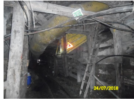
Sistema de ventilación de chimeneas
