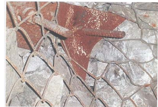
Figura 2.2: Deformación de planchuelas debido a cargas.
