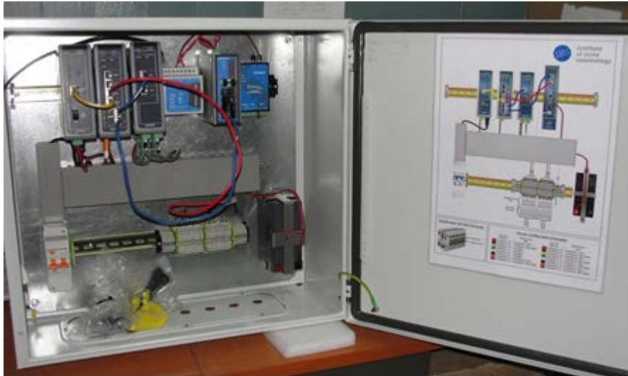
Estación microsísmica subterránea IMS
