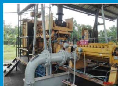
Estación Andoas – Bomba Centrífuga BA-16A
