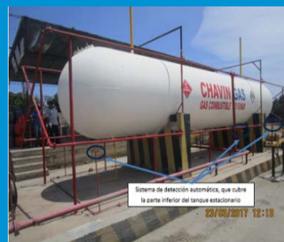
Planta Envasadora de GLP con capacidad de 10,000 Glns
