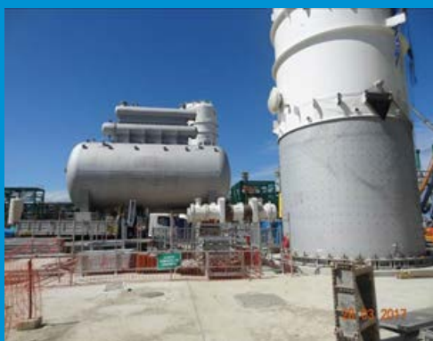
Equipos de la Unidad Flexicoking
