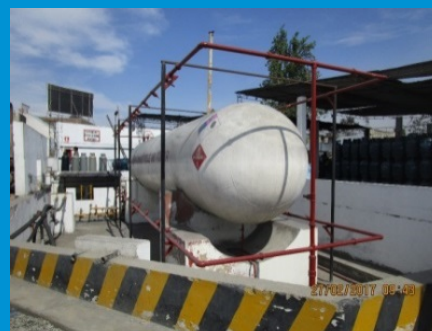
Planta Envasadora de GLP con capacidad de 10,000 Glns
