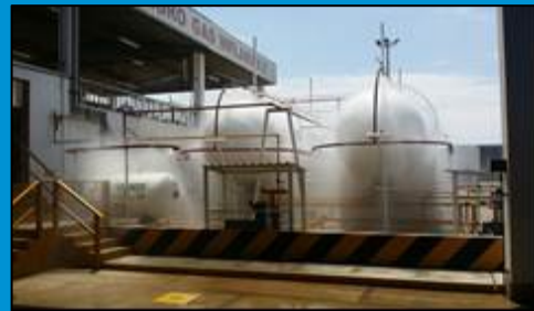
Vista de la Planta Envasadora Santo Toribio Gas – La Libertad
