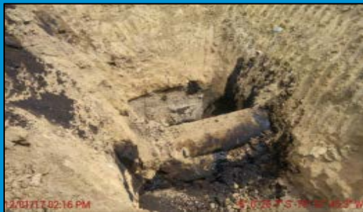
Km.570+187.7, filtración de crudo y tierra contaminada alrededor de la tubería
