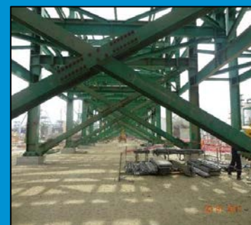
Rack de tuberías de las unidades de FCK y PAR (Aire Comprimido).
