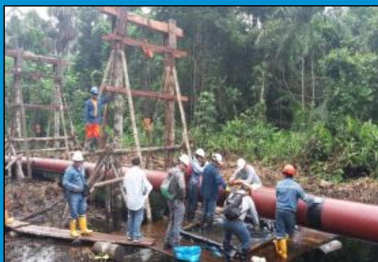
Km.24+800, inspección del sector afectado
