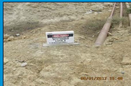
Ducto a ser retirado, como parte del Plan de Abandono. Lote X-CNPC
