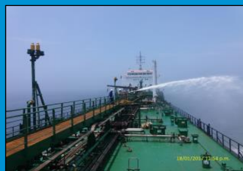
Vista de la prueba al sistema contraincendios del B/T Santa Clara B
