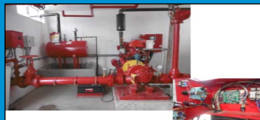
Bomba contra incendio y su tablero
