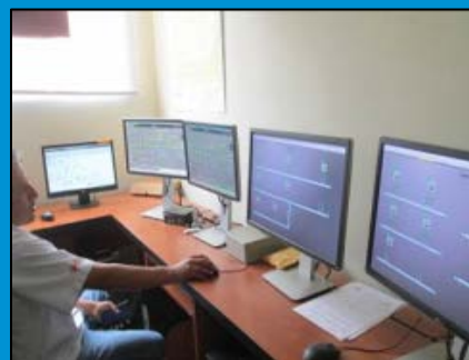
Inspección del Sistema SCADA - Talara
