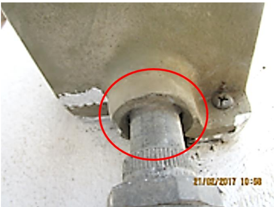
Fig 11.6 Montaje inadecuado de tuberías y accesorios.
