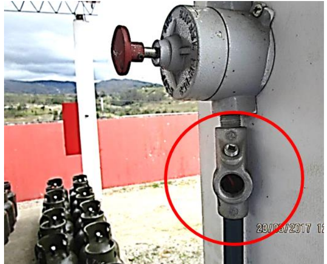
Figura 11.7: Falta de material sellante en accesorio instalado en áreas clasificadas.
