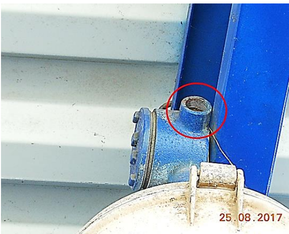
Fig. 11.2: se dejó abierta un entrada de la caja de conexiones apta para áreas clasificadas.
