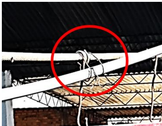
Fig. 11.12: Tubería sin soportes, instalación improvisada.
