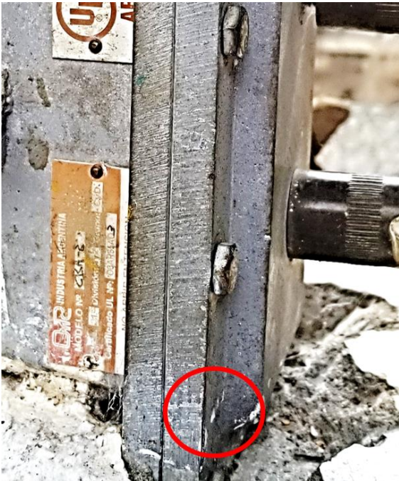
Fig. 11.5: Durante el mantenimiento a este envoltorio apto para áreas clasificadas se retiró un perno y no se volvió a colocar.
