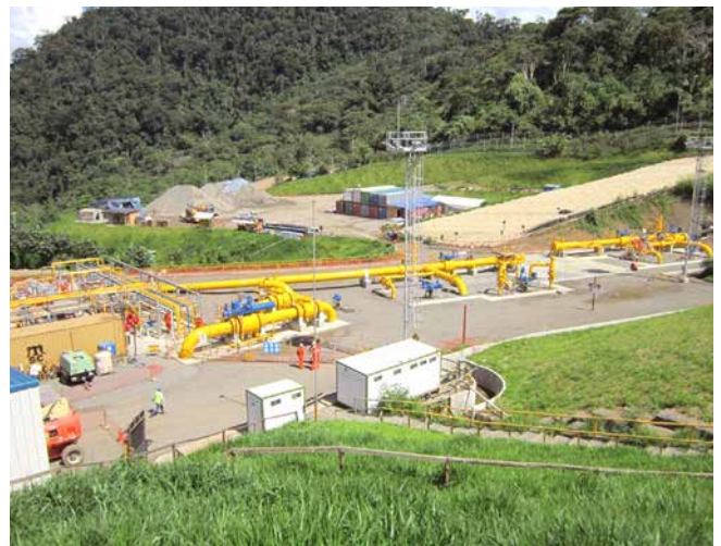
Vista de la planta de compresión Kepashiato
