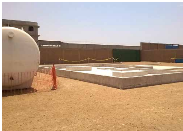
Pacasmayo: Vista de cubeto y pedestales de Tanque
