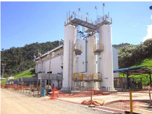
Tanques cilíndricos que contienen aire para el sistema de instrumentación de la Planta compresora
