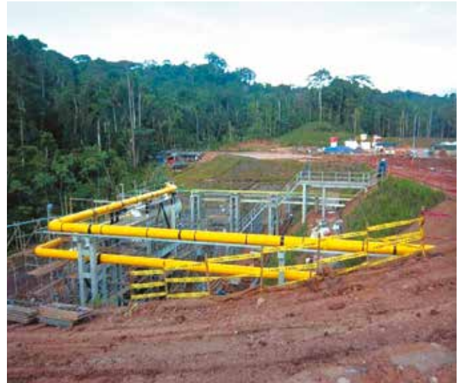
Sistema de Flare de la locación Mipaya – Lote 56 con el Knock Out Drum instalado.
