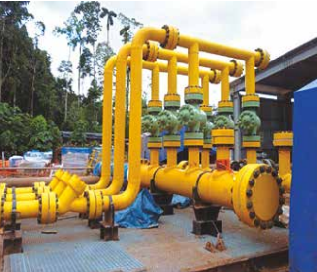
Múltiple de colección del gas de producción de la locación Mipaya – Lote 56.
