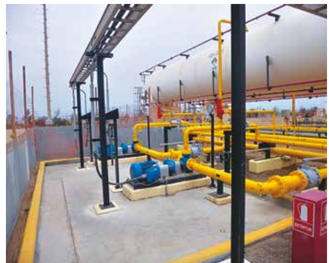
Bombas actuales de carga de butano. Cuando se implemente el proyecto, quedarán en su misma ubicación como bombas de recirculación.
