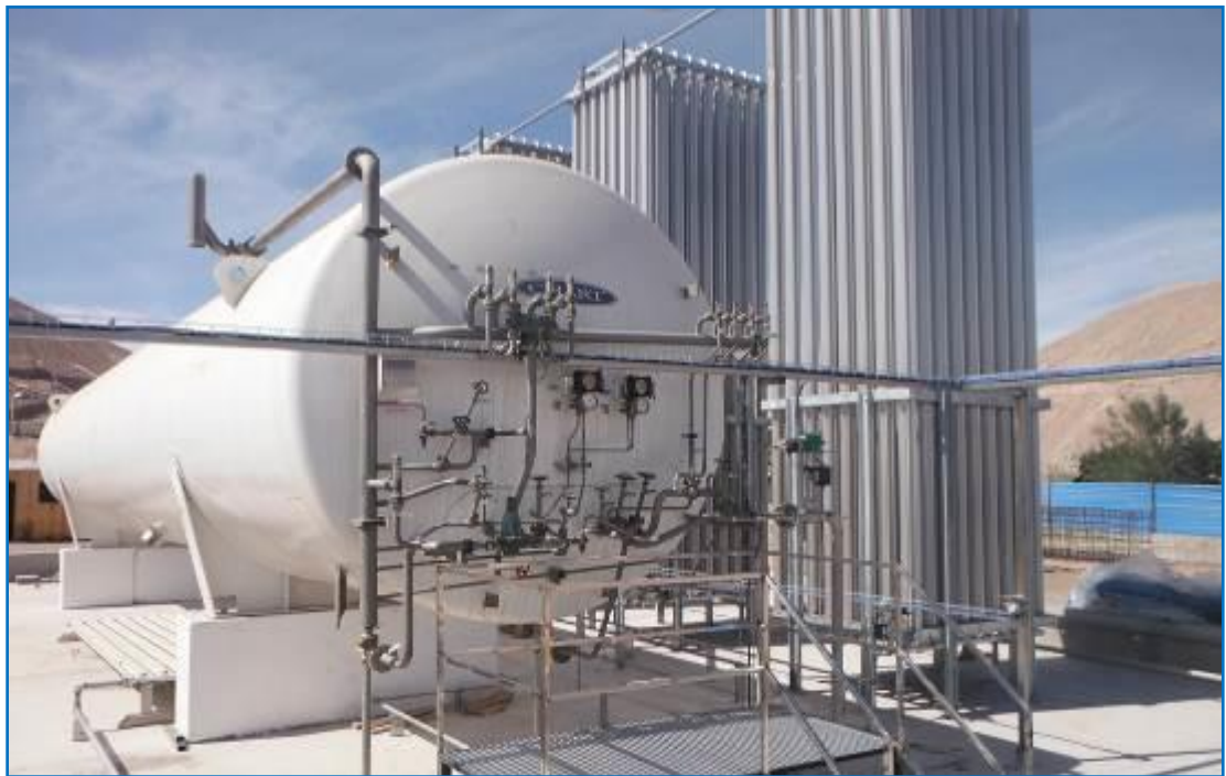
Foto 03.- Vista de la Estación de Distrito MOQUEGUA
