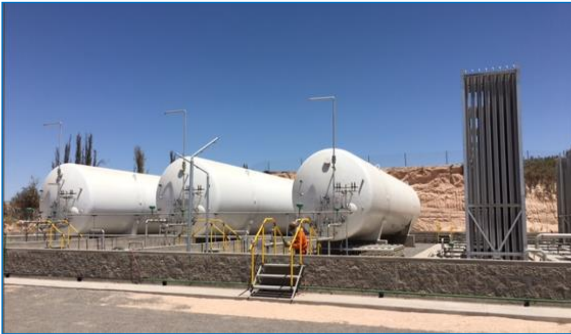
Foto 01.- Vista de la Estación de Distrito AREQUIPA NORTE
