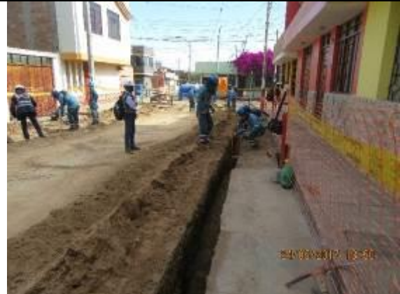
Foto 15.- Redes Tacna: verificación de instalación de tubería de 25 mm en zanja en el Distrito de Tacna.
