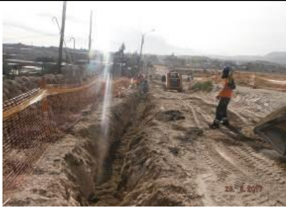
Foto 14.- Redes Arequipa: Se verifica la aplicación de material de reposición en Distrito Cerro Colorado.
