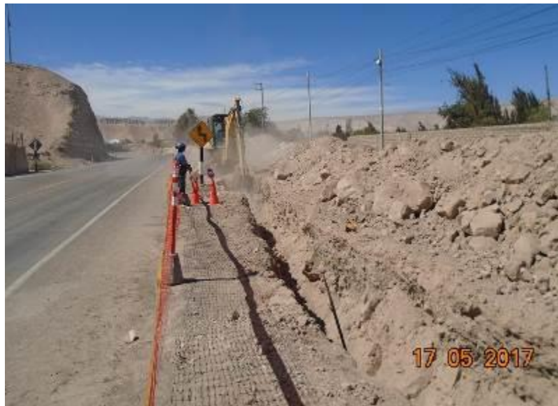
Foto 12.- Redes en Moquegua: Excavación de zanja en carretera Binacional para la instalación de tubería de PE Ø 160mm.
