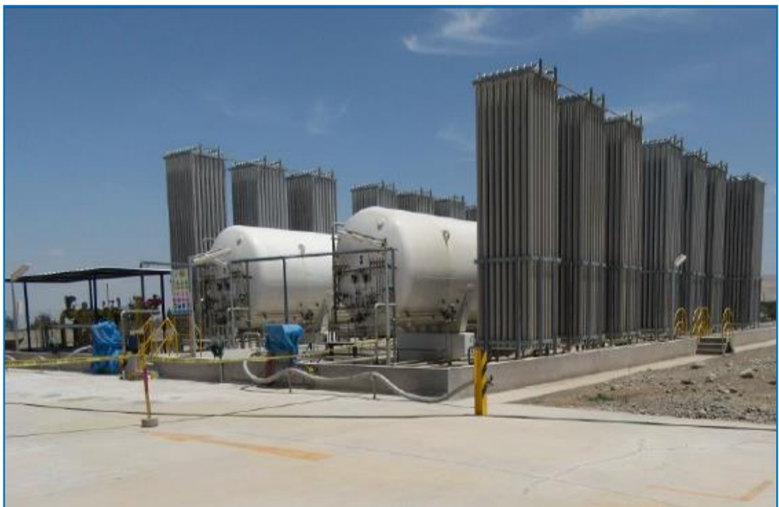
Foto 04.- Vista de la Estación de Distrito TACNA
