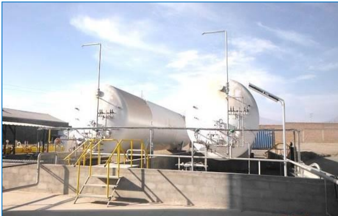
Foto 02.- Vista de la Estación de Distrito AREQUIPA SUR
