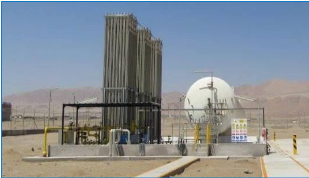
Foto 05.- Vista de la Estación de Distrito ILO
