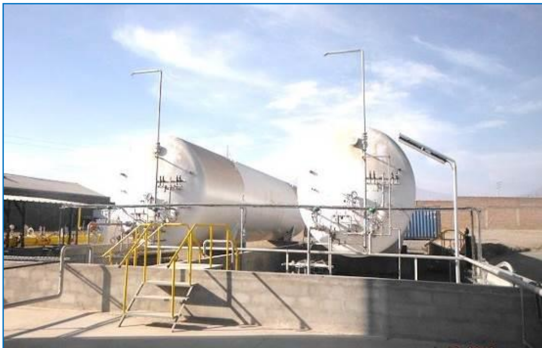
Foto 2.- Vista de la Estación de Distrito AREQUIPA SUR
