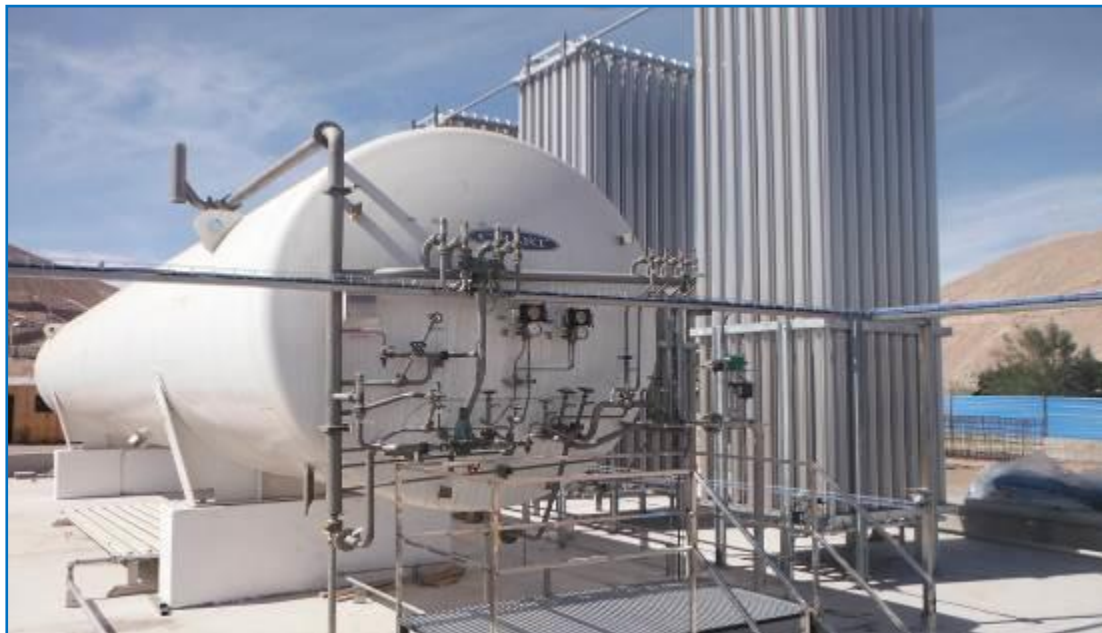
Foto 3.- Vista de la Estación de Distrito MOQUEGUA
