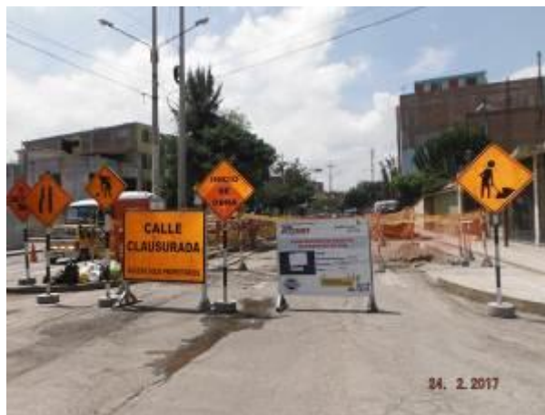
Foto 17.- Instalación de Redes en Arequipa: verificación de señalización en ubicación de labores diarias.
