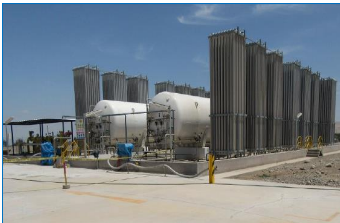
Foto 4.- Vista de la Estación de Distrito TACNA
