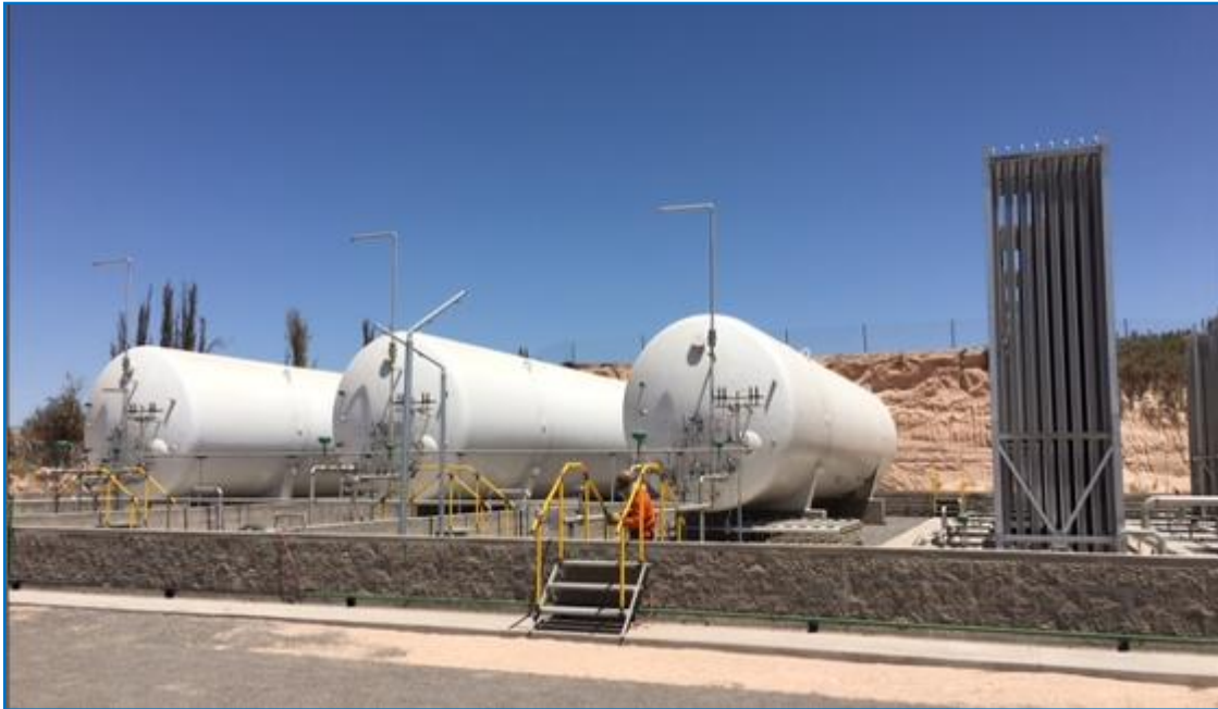
Foto 1.- Vista de la Estación de Distrito AREQUIPA NORTE
