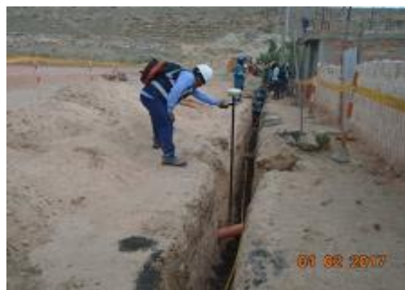
Foto 16.- Instalación de Redes en Arequipa: verificando toma con GPS de ubicación de tubería e interferencias
