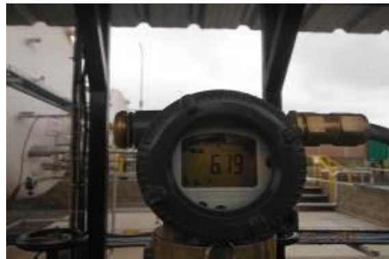
Foto 12.-Estacion Norte: Pruebas de sensores de presión.
