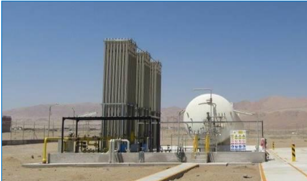
Foto 5.- Vista de la Estación de Distrito ILO
