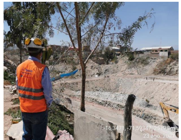
REDES AREQUIPA: Supervisando la presencia de personal de PPD de PETROPERU, realizando labores de verificación de los trabajos de excavación en la quebrada Añashuayco del Distrito de Cerro Colorado.
