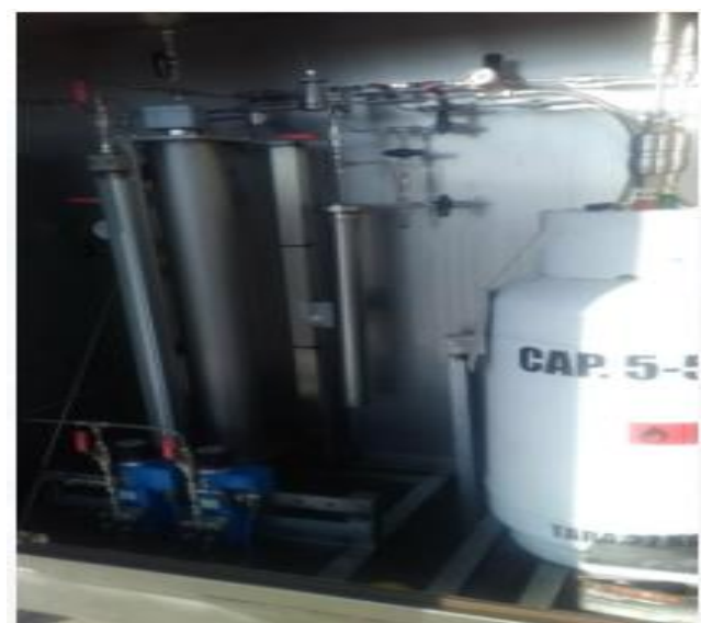
ESTACION DE DISTRITO LA JOYA (AREQUIPA): Supervisión de la instalación y montaje de válvulas y tubería de acero inoxidable al Equipo de inyección de odorante.
