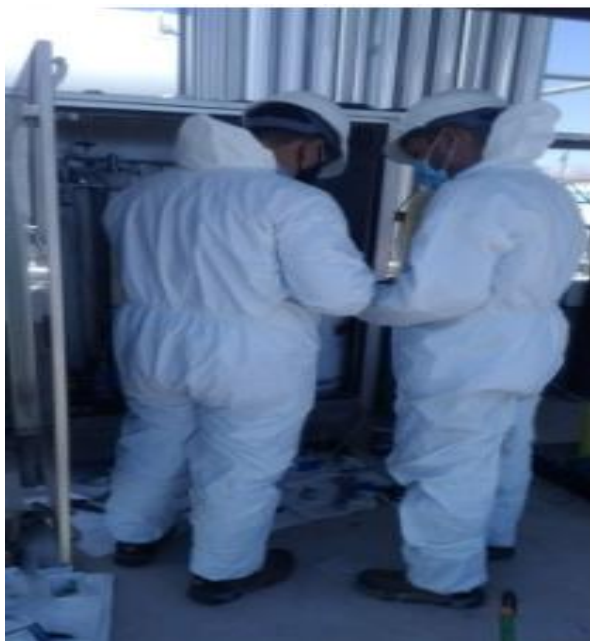
ESTACION DE DISTRITO LA JOYA (AREQUIPA): Supervisión de la instalación y montaje de válvulas y tubería de acero inoxidable al Equipo de inyección de odorante.
