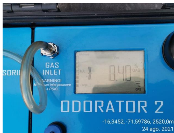
ODORIZACION AREQUIPA: Verificación la lectura de la muestra tomada 0.40 % del GN en el ambiente - E.D. La Joya.
