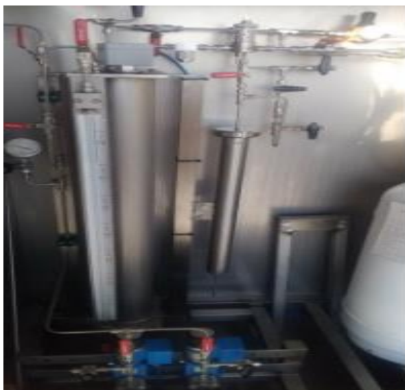
ESTACION DE DISTRITO LA JOYA (AREQUIPA): Supervisión de la instalación y montaje de válvulas y tubería de acero inoxidable al Equipo de inyección de odorante.
