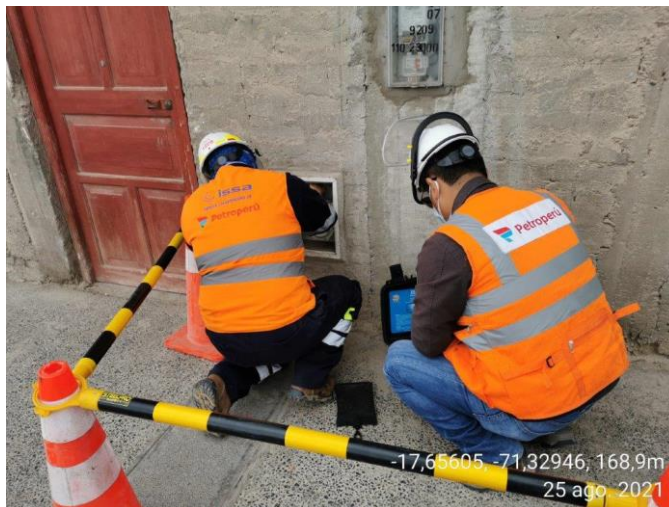
ODORIZACION ILO: Verificando toma de muestra con equipo ODORATOR 2 con serie N° 2101744003 utilizado en la muestra de la Urb. Siglo XXI Mz.G Lt. 07, distrito de ILO.
