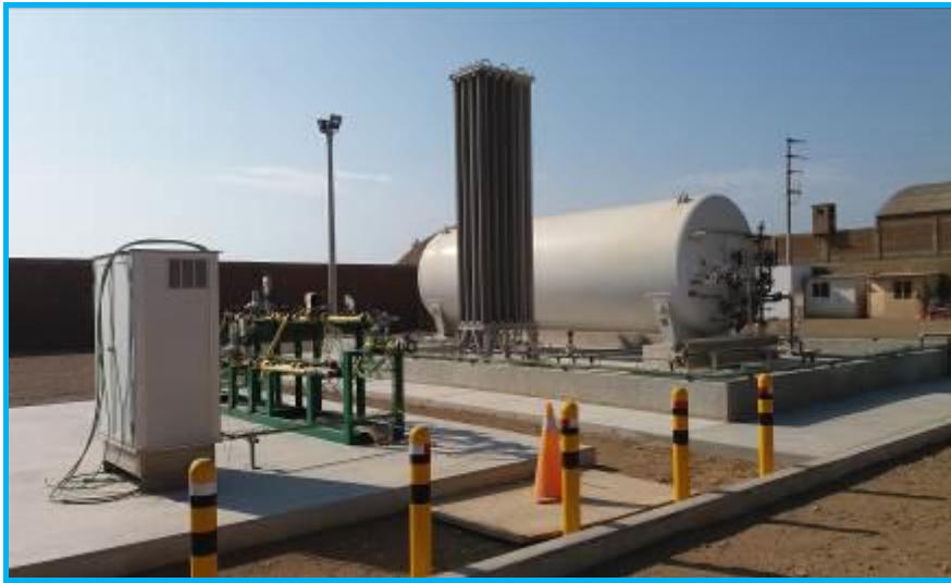
Foto 08.- Vista de la zona de procesos de la estación de distrito.
