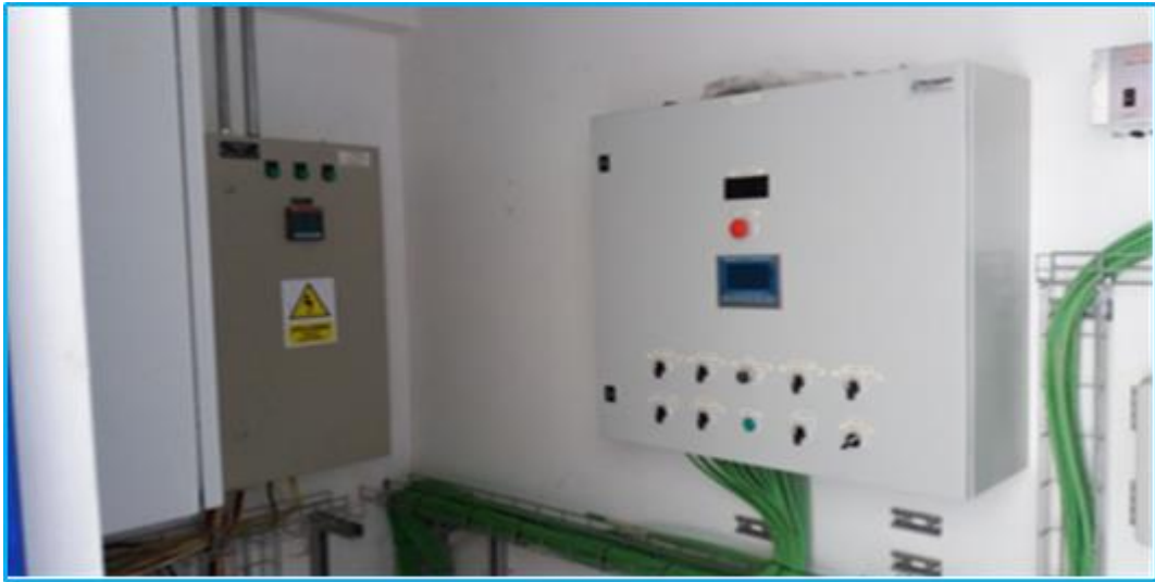
Foto 03.- Vista de cuarto de tableros eléctricos.
