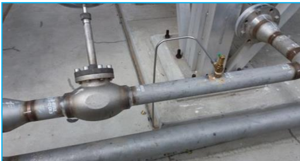
Foto 04.- Vista de la instalación de tubing de 3/8" desde la descarga de la válvula de alivio hacia un colector.
