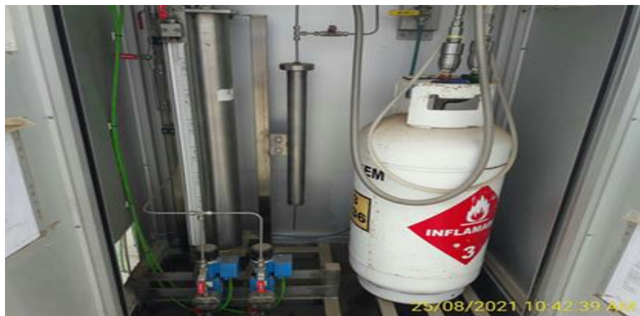
Foto 25.- Gabinete del sistema de odorización en operación normal. Volumen de Tk. 7 litros.
