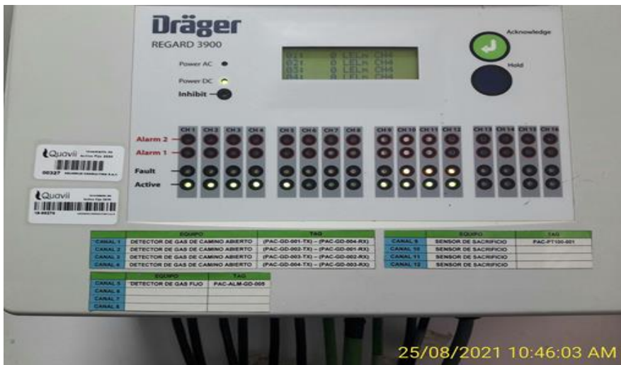
Foto 24.- Panel de detector de llama y sensor de sacrificio en área de procesos: 0% de LEL EX.
