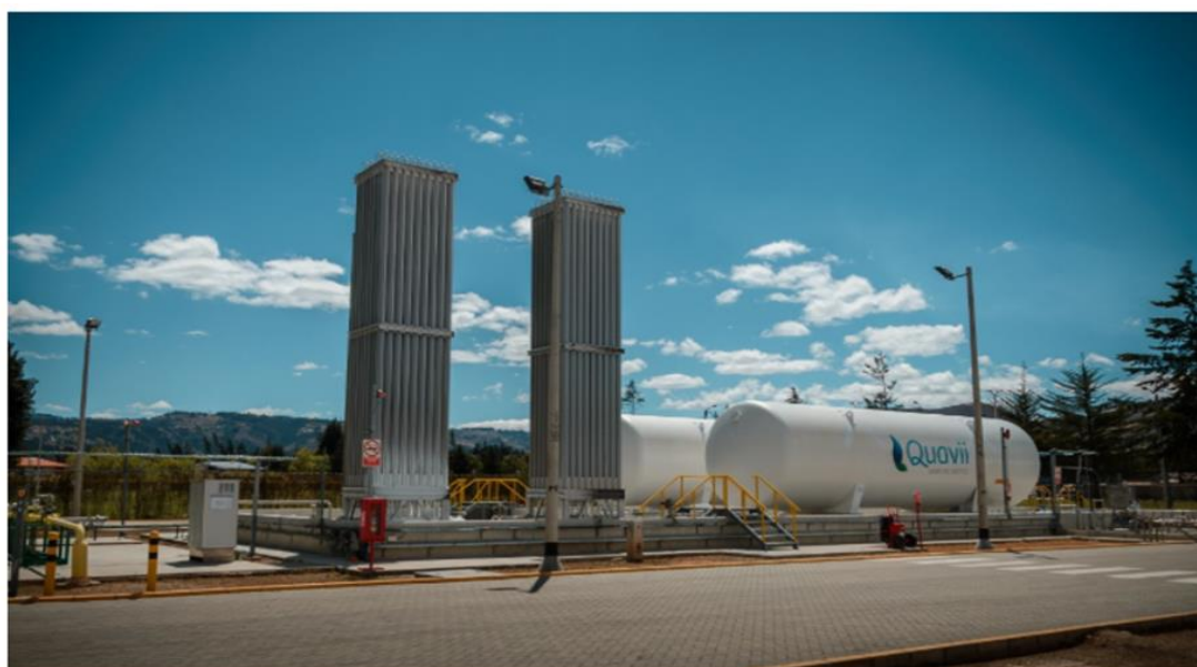
Ref. Vista de la E.D. Cajamarca.
