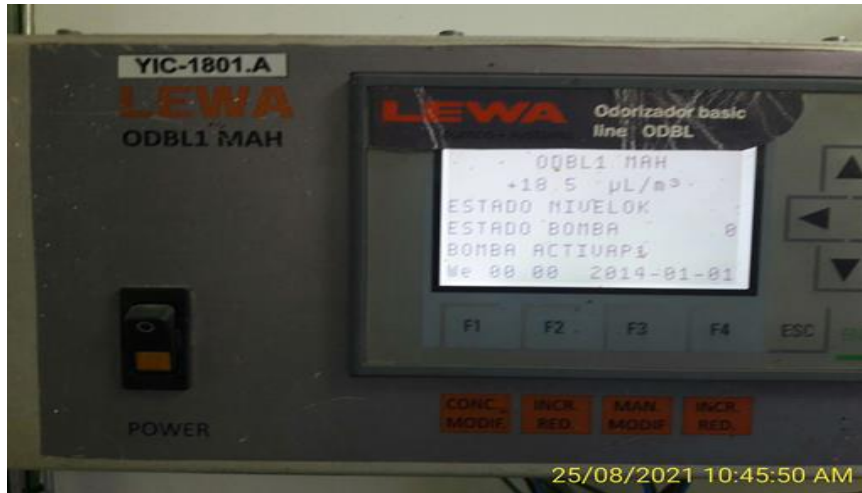
Foto 23.- Se verifica la dosificación de odorante a la red de distribución: 18.5 µL/m3.
