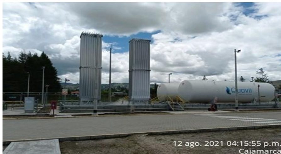
Foto N°22.- Vista de la ED de Cajamarca.
