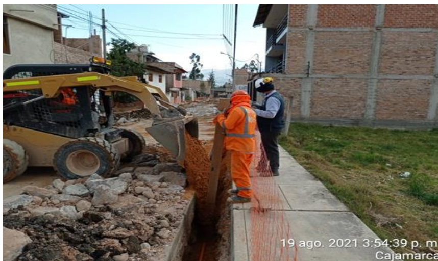
Foto N° 5 .- Se verifica cumplimiento de la cama y relleno de zanja con arena fina.
