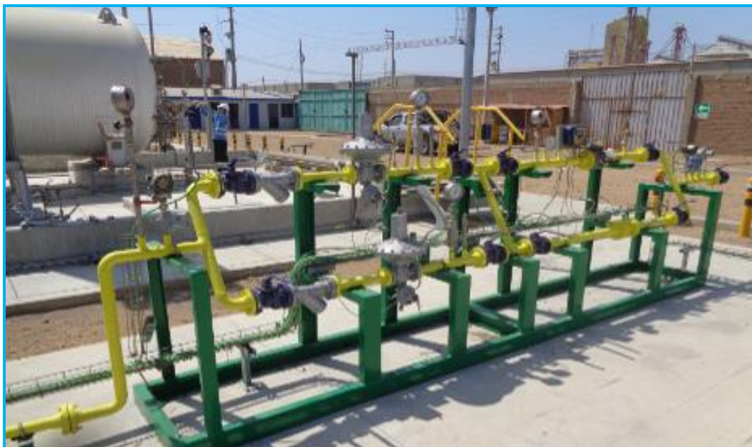
Foto 02.- Vista de la Estación de Distrito de Pacasmayo, zona de la ERM
