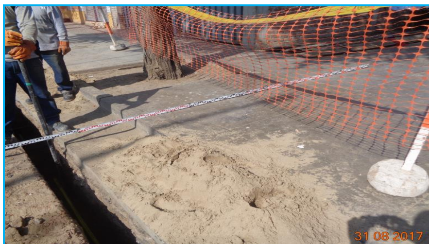
Foto 09.- Redes Trujillo, vista de la verificación de la distancia de la tubería de gas a los límites de propiedad, mínimo 1m, el cual cumple con la norma - Calle Chiclayo Urb. Aranjuez.
