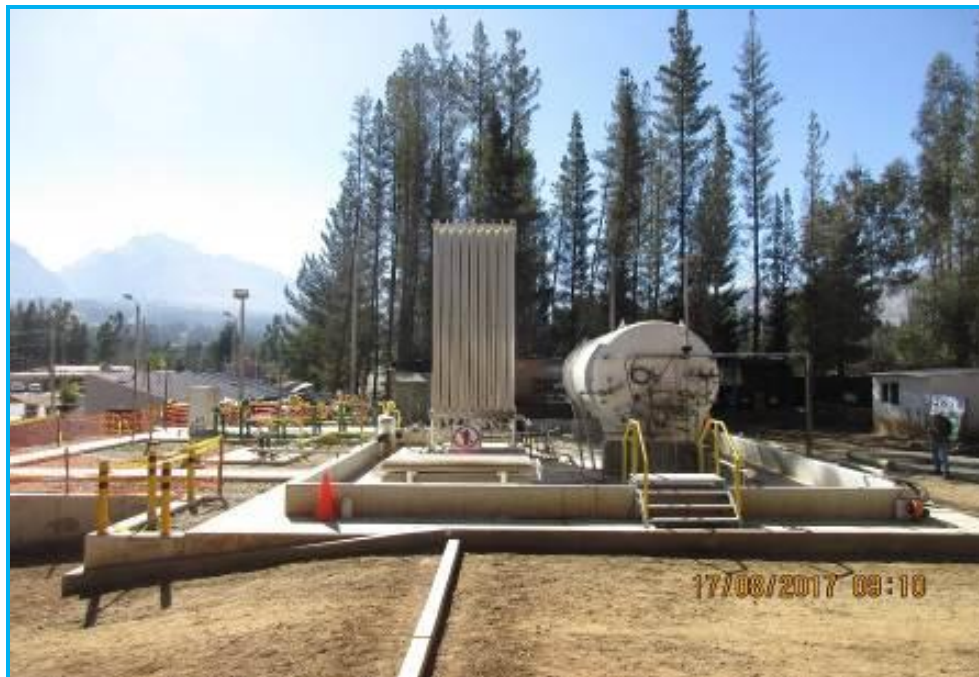
Foto 06.- Vista de Estación de Distrito de Huaraz.
