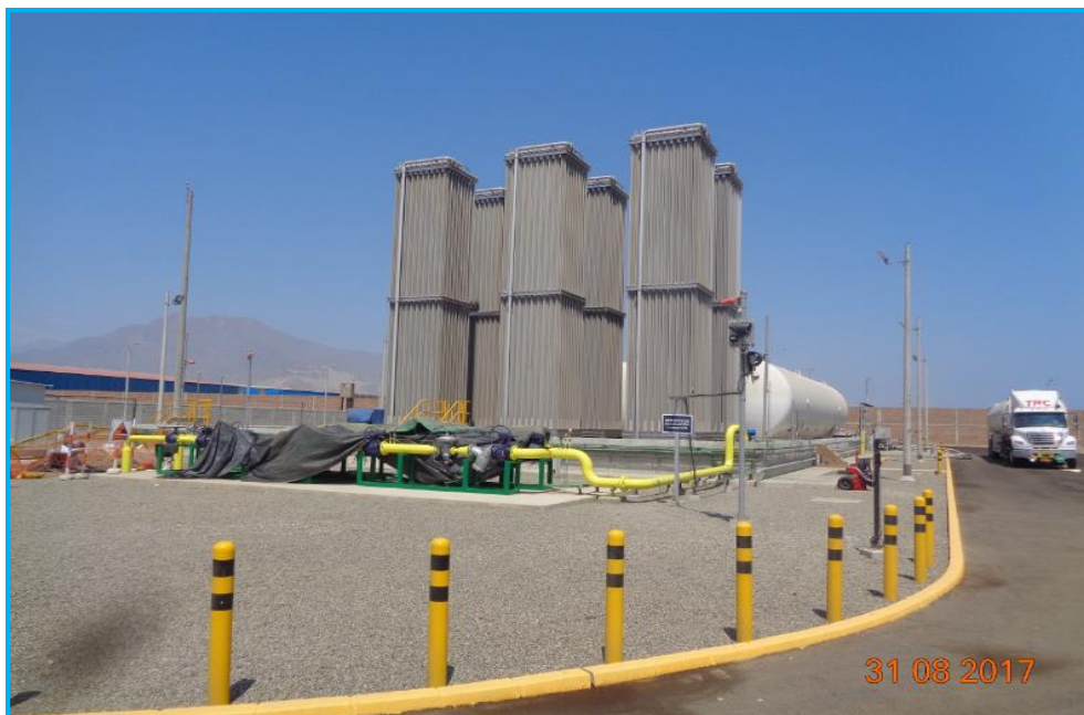
Foto 01.- Vista de la Estación de Distrito de Trujillo
