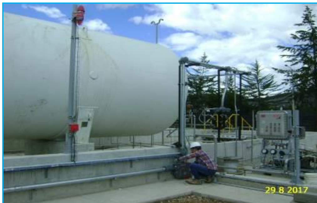
Foto 07.- Vista de E.D. Cajamarca, instalación eléctrica a la bomba criogénica.
