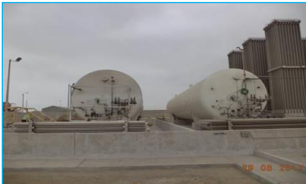
Foto 05.- Vista Estación de Distrito de Chimbote
