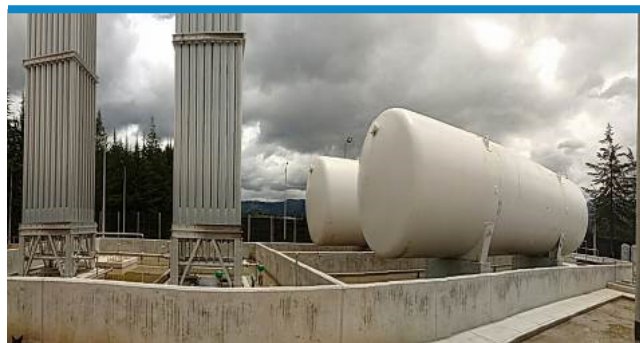
Vista de la Estación de Distrito de Cajamarca.
