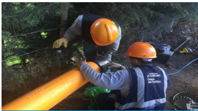
Redes Cajamarca: Instalación de tubería de PE Ø200 mm en cruce especial del Río Mashcon.
