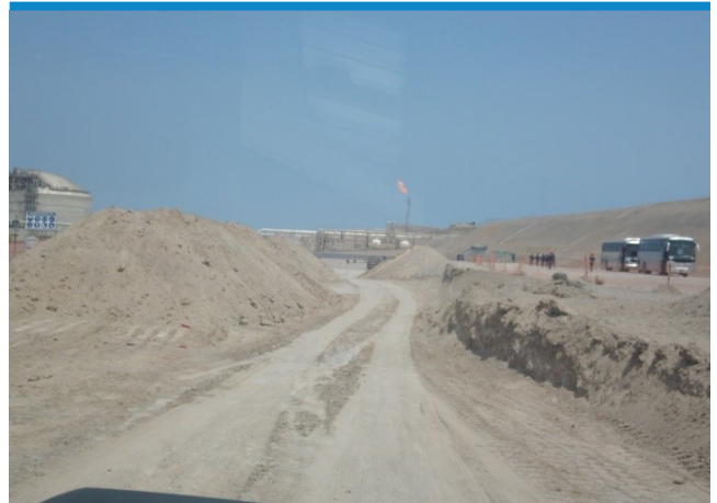
Vista panorámica del acceso de camiones a cargadero de GNL.
