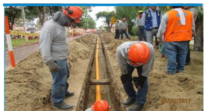
Redes de Trujillo: Vista del traslado de tubos de HDPE de Ø200mm en la cuadra 4 de la Avenida Túpac Amaru.
