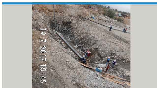
Bajada de tubería, Extensión de Red a Protissa, distrito de San Vicente de Cañete, provincia de Cañete.
