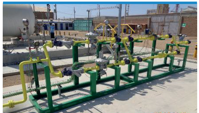
Vista de la Estación Distrito de Pacasmayo, zona de la ERM.
