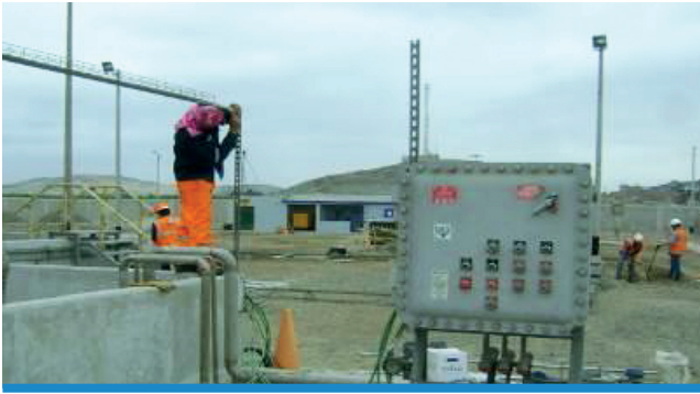
Vista Estación de Distrito de Chimbote. Zona de bombas de trasiego de GNL
