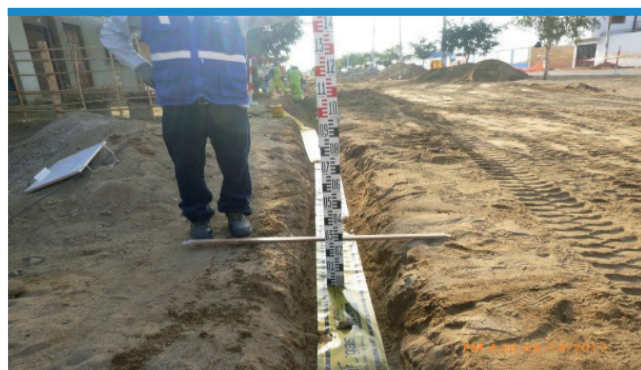
Verificación de la cinta de seguridad, Proyecto PE-17-101 Sector Unión, distrito Pueblo Nuevo, Provincia de Chincha.
