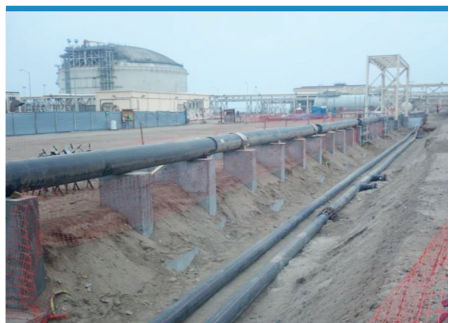
Vista de las tuberías contra incendios.
