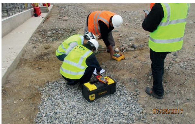
Redes Tacna: Verificación de la medición del sistema de puesta a tierra con equipo telurómetro.
