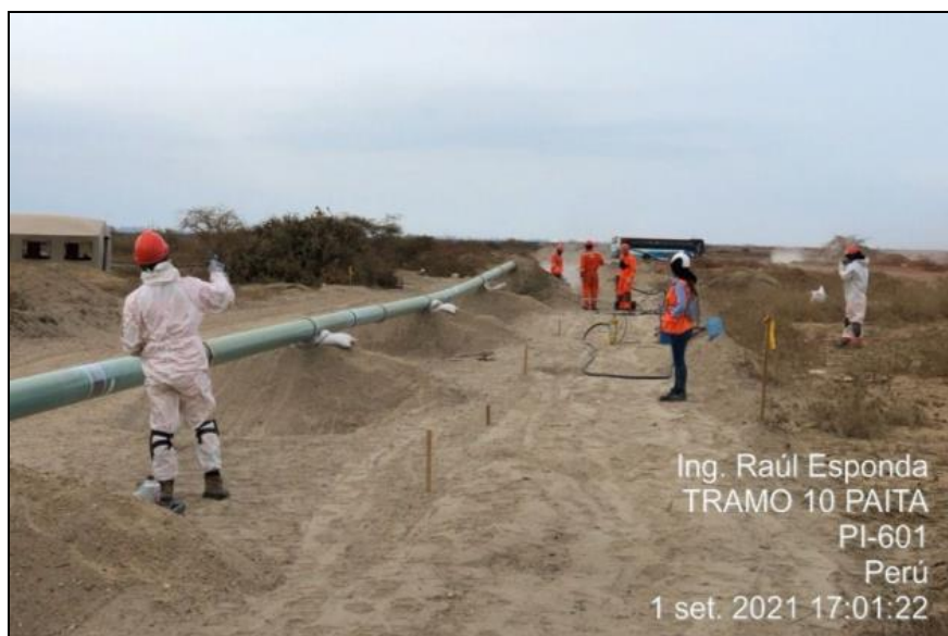
Foto: Aplicación de capa de revestimiento en juntas soldadas del tramo 10, luego de realizar el arenado en la unión soldada.
