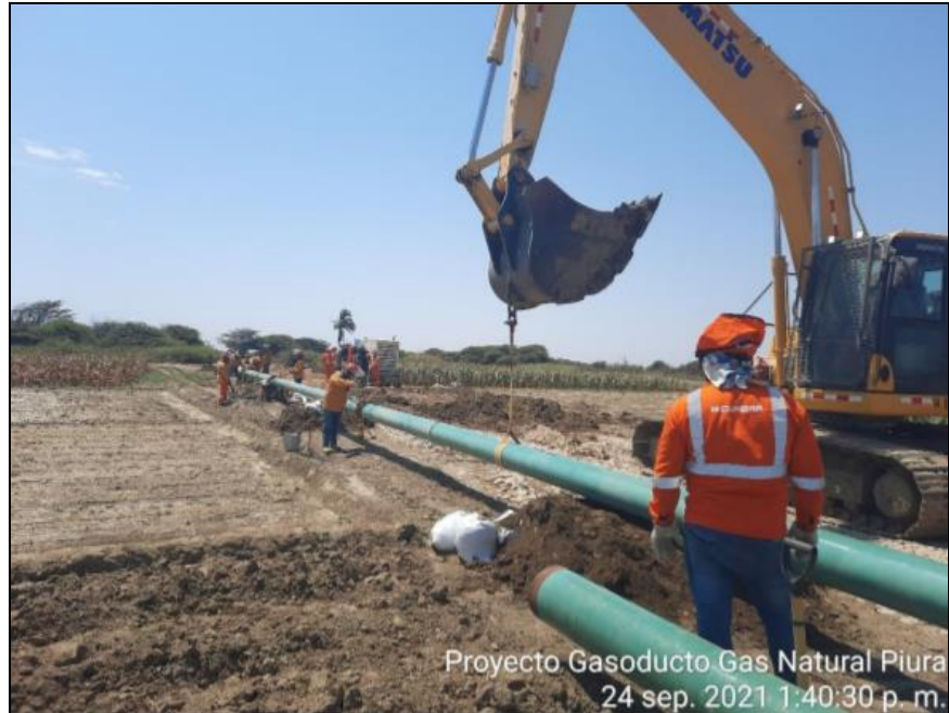
Foto: Se aprecia el alineamiento de tuberías como parte de los trabajos preliminares para la construcción del tramo 3 del gasoducto.
