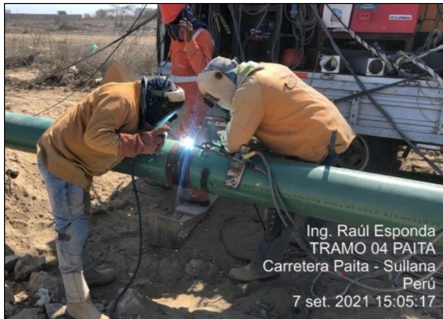
Foto: Proceso de soldadura de tubería de \varnothing 10'' correspondiente al tramo 4 del gasoducto.
