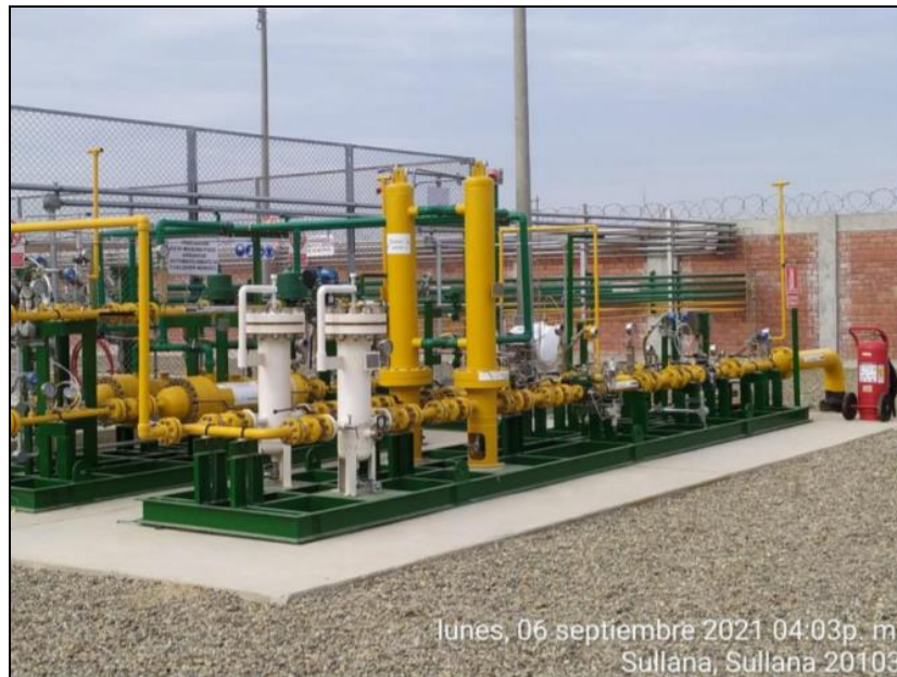
Foto: Se observa la zona de regulación y medición de gas natural Estación de Sullana
