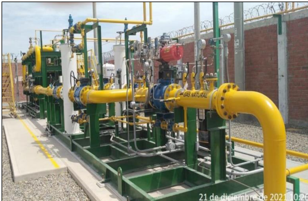
Foto: Se observa los skid de regulación y medición de la estación de Piura
