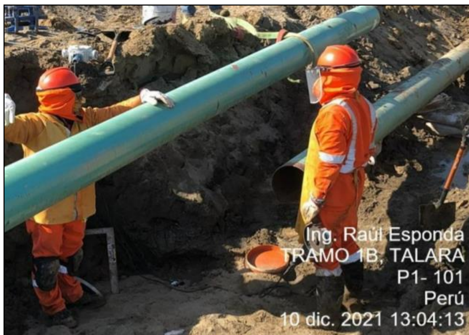
Foto: Se aprecia los trabajos de alineamiento de tuberías Ø10", previo al proceso de soldadura, corresponde a la construcción del tramo 1B del gasoducto.
