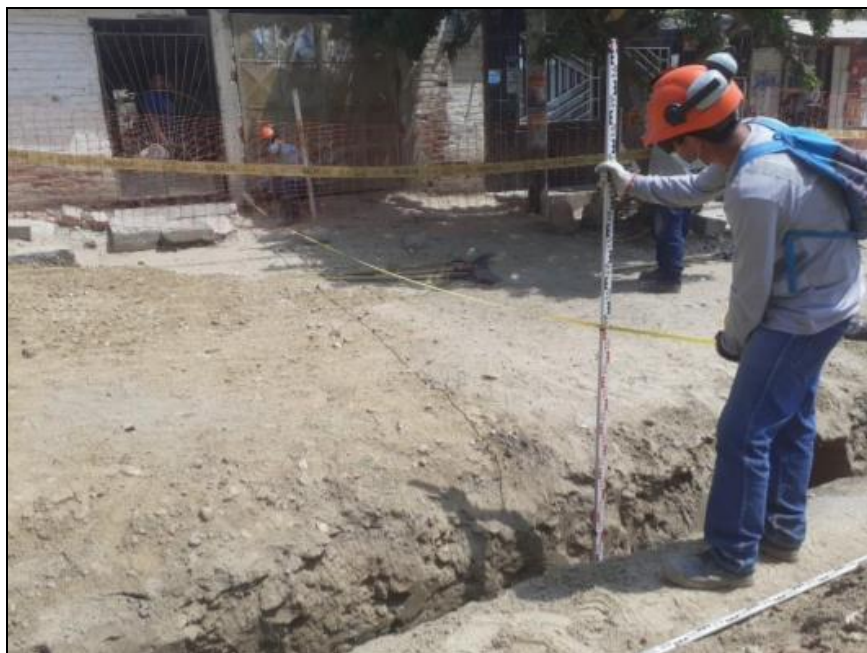
Foto: Se aprecia la verificación del cumplimiento de la distancia mínima de 1 m. que debe existir entre la tubería de gas y el límite de propiedad.
