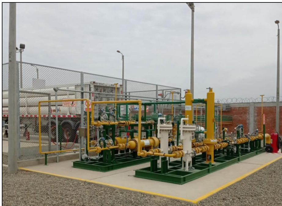
Foto: Se observa la zona del skid de regulación y medición de gas - Estación de Sullana
