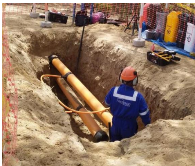
Foto: Se verifica los trabajos realizados de empalme de tubería de polietileno de \varnothing 110 mm.
