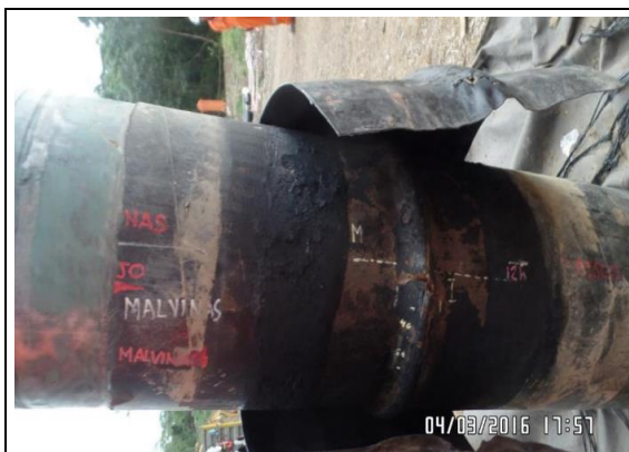
Imagen 18: Vista del tramo de tubería fallada con retiro parcial de la protección de la junta J56/46. (04.03.2016)
