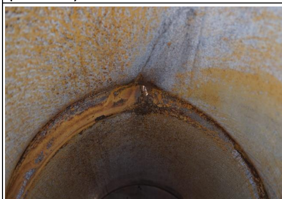
Imagen 20: Vista interior de la rotura del ducto fallado. (30.03.2016)
