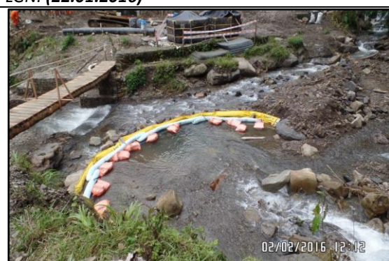
Imagen 10: KP 56+300, Vista de barrera de contención con disposición de material absorbente para retención de trazas de LGN. (05.02.2016)
