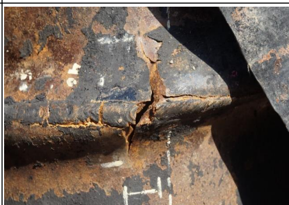
Imagen 21: Vista exterior de la rotura del ducto fallado. (30.03.2016)
