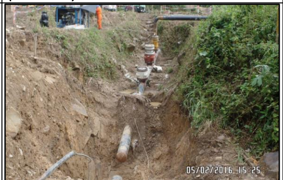
Imagen 17: Punto de discontinuidad del ducto de LGN aguas abajo de ubicación de la falla donde se aprecia. (05.02.2016)
