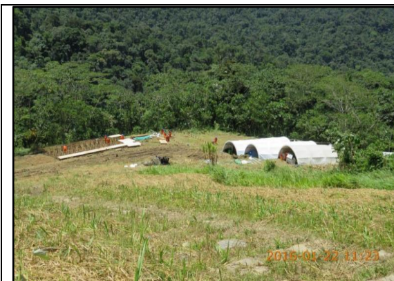
Imagen 05: KP 57+000, Construcción de campamento provisional para el personal que trabajó en la reparación del ducto de LGN. (22.01.2016)
