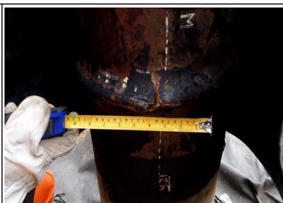
Imagen 19: Vista de la medición de la falla en la junta J56/46. (04.03.2016)
