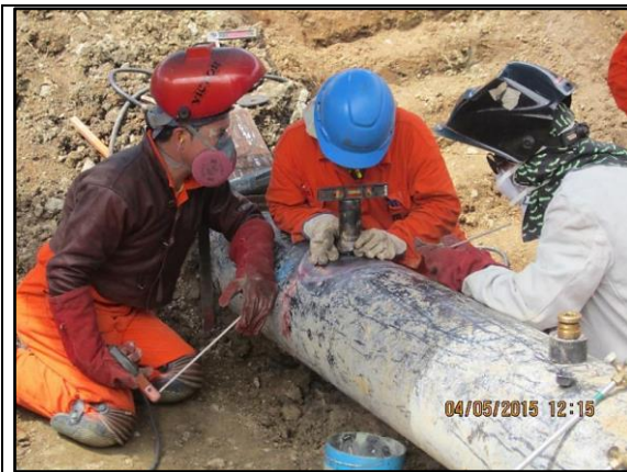
Imagen 14: Instantes del soldeo de uno de los weldolet sobre la tubería por donde se realiza el venteo y quema de los vapores remanentes de LGN. (04.05.2015)
