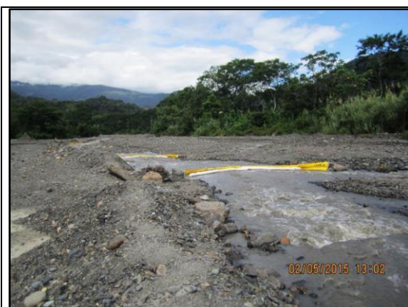
Imagen 07: Vista tomada a orillas del río Kintipiri, donde se aprecia las barreras de contención y paños absorbentes colocados para recuperar parte del hidrocarburo derramado. (02.05.2015)
