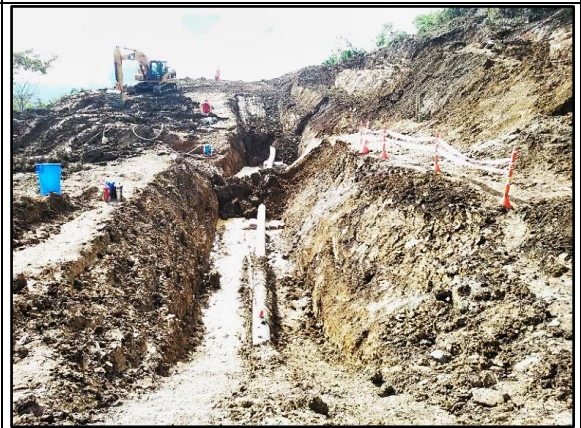
Imagen 17: Vista panorámica en la que se aprecia el ducto de LGN después de la reparación. (06.05.2015)
