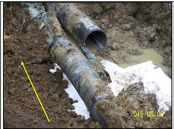
Imagen 15: Posición que quedó las secciones de tubería después del corte para aliviar tensiones y posibilitar extraer la probeta conteniendo la falla. La flecha amarilla indica el sentido del flujo de LGN. (05.05.2015)
