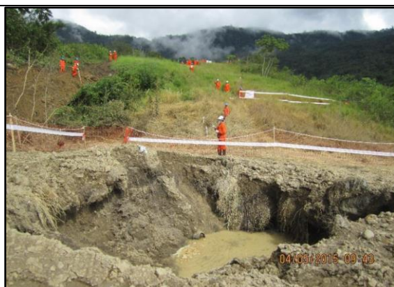
Imagen 04: KP-183+644. Hoyo originado por la explosión sin fuego, al producirse la fuga de LGN. No se registraron daños personales ni a la propiedad. (04.05.2015)
