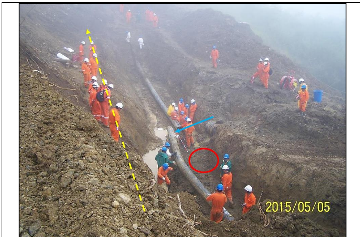
Imagen 13: Vista en la cual se aprecia la exposición de cerca de 40 metros lineales de tubería. La flecha amarilla discontinua indica el sentido del flujo de LGN, el círculo rojo la ubicación de una roca y la flecha celeste indica a ubicación del punto de rotura de la tubería. (05.05.2015)
