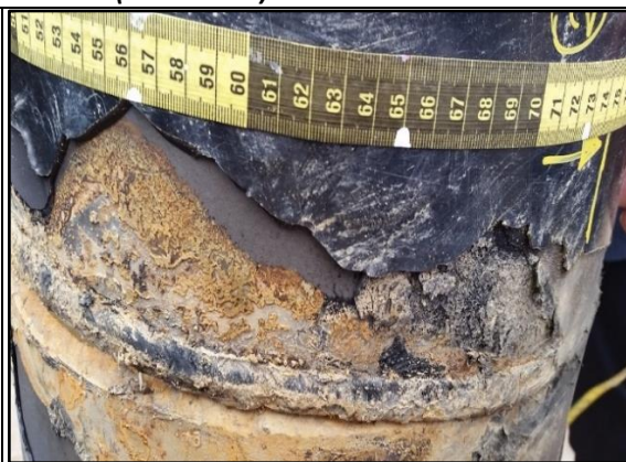
Imagen 20: Vista de la rotura de la tubería el cual tiene una de longitud.79.5 cm.
