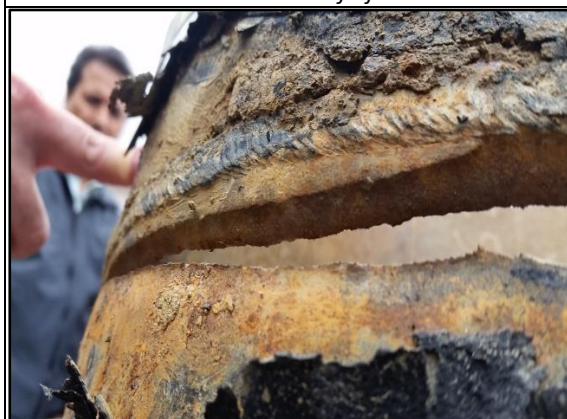
Imagen 19: Vista de la rotura que está próxima a la soldadura.
