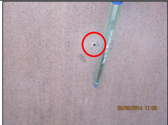
Imagen 16: Vista interior de la tubería, se observa el agujero de aprox. 2.5 mm de diámetro, que atravesó la pared del tubo. (20.06.2014)
