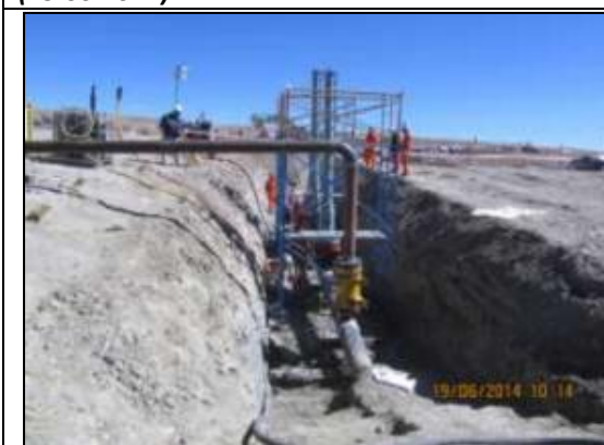
Imagen 19: Habilitación del By-Pass de 10" para re-direccionar flujo de LGN y aislar tubería averiada para proceder a su reparación.
