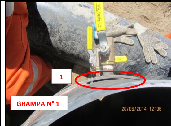
Imagen 15: Vista de la primera válvula (superior) instalada en la grampa N° 1, por donde se presume se produjo el derrame de LGN.
