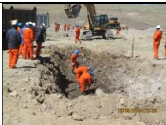
Imagen 20: Intervención del área donde se detectó el incidente de falla en el STD-LGN. (19.06.2014)
