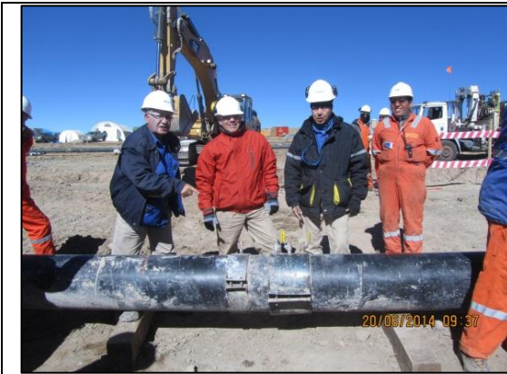
Imagen 13: Vista de la sección afectada donde se instaló dos grampas de metal. La primera llevaba instalada 03 válvulas, mientras que la segunda tenía un niple. (20.06.2014)
