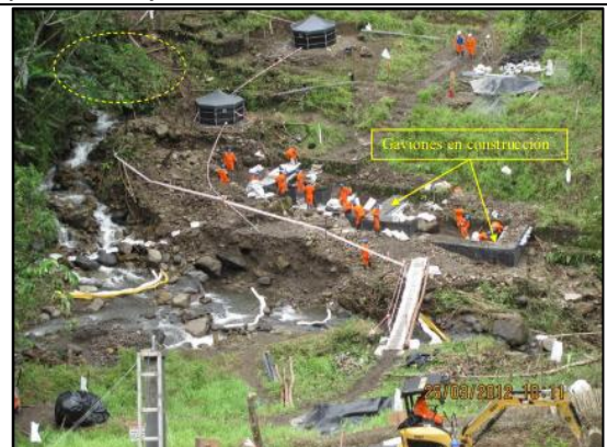
Imagen 10: KP 56+600, instalación de Fast Tanks para el almacenamiento temporal de LGN, en el círculo amarillo se indica la poza de recuperación de este producto. (26.03.2012)
