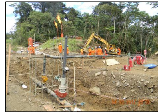
Imagen 14: Vista de uno de los Hot Taps con ducto By-Pass acoplado. Al fondo se observa los flares quemando LGN. (03.04.2012)
