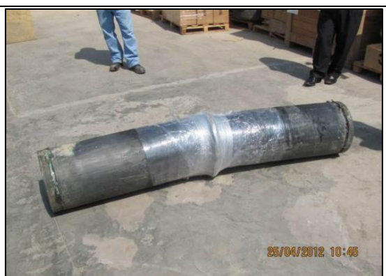
Imagen 19: Inspección visual de la sección de tuberías extraída en el City Gate Lurín de TGP. (25.04.2012)
