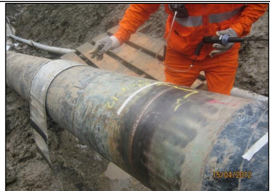
Imagen 17: Vista del empalme de tubería de remplazo, aguas debajo del punto de fuga. (15.04.2012)
