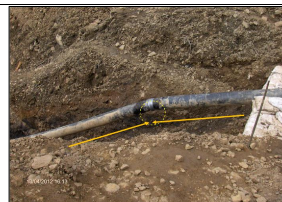
Imagen 18: Arrugamiento en la soldadura circunferencial de Tie-in T35T. Se colocó cinta protectora circundante a la falla para evitar la fuga de remanentes de producto. (13.04.2012)
