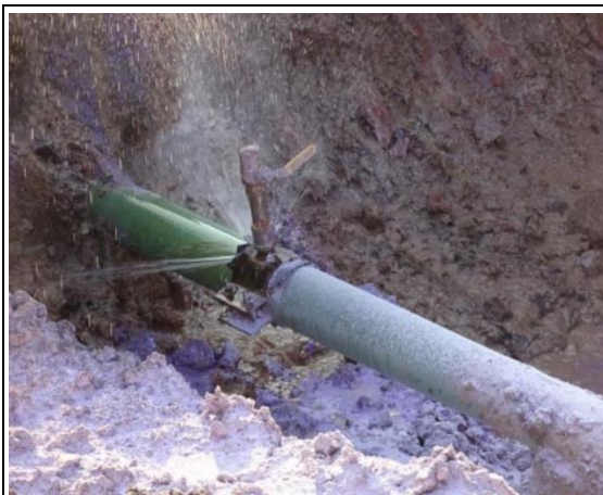
Imagen 20: Vista de la conexión clandestina (Abrazadera hecha de 4" con conexión a niple de 1") en KP 83+137 (Fuente Aguaytia)
