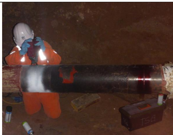
Imagen 11: Vista de la ejecución de END ( partículas magnéticas ) como parte de las actividades de reparación del ducto de 10'' de GN en KP 40+000. (Fuente Aguaytia)
