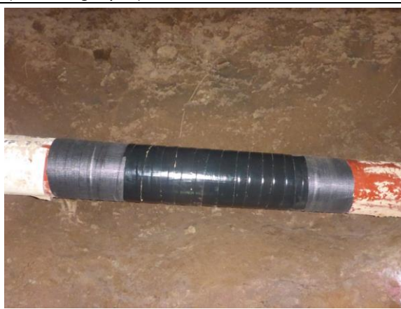
Imagen 13: Vista de la reparación del revestimiento ducto de 10'' de GN en KP 40+000 mediante la aplicación de recubrimiento epóxico anticorrosivo (Fuente Aguaytia)
