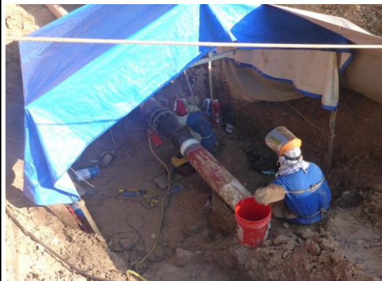
Imagen 08: Vista de la ejecución de la soldadura del niple de remplazo (Fuente Aguaytia)
