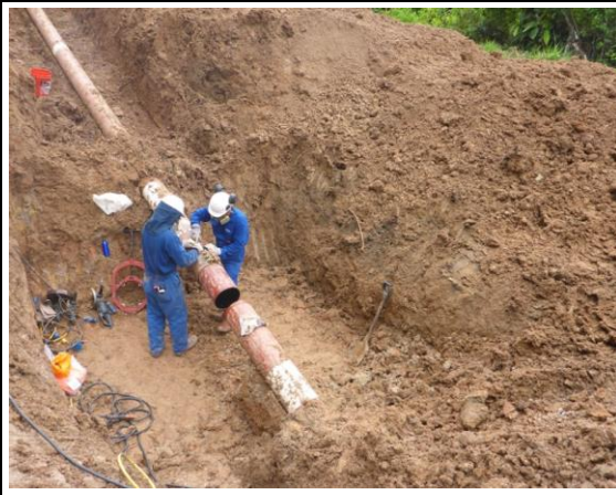
Imagen 04: Vista del corte en frío de la tubería intervenida del ducto de 10" de GN en el KP 40+000 (Fuente Aguaytia)
