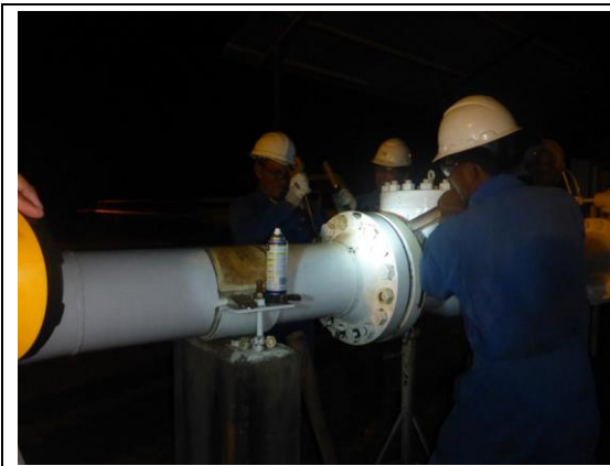
Imagen 02: Vista del bloqueo de la válvula de 10" en la estación Neshuya e instalación de plato ciego. (Fuente Aguaytía)
