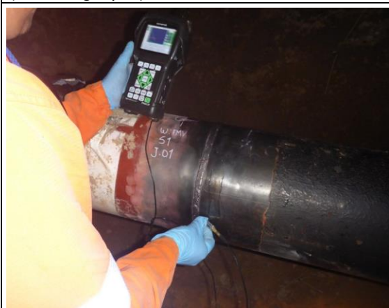
Imagen 12: Vista de la ejecución de END ( ultrasonido ) como parte de las actividades de reparación del ducto de 10'' de GN en KP 40+000. (Fuente Aguaytia)
