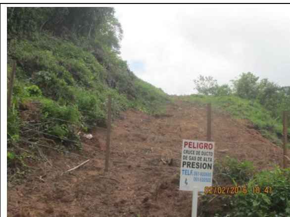
Imagen 16: La supervisión de Osinergmin verificó la restauración del área afectada por los trabajos de reparación dentro del Derecho de Vía (KP 40+000).
