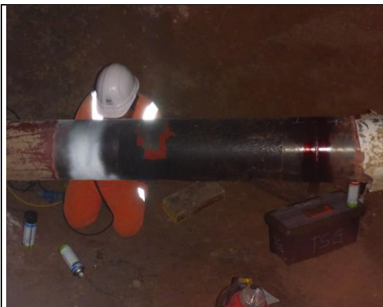
Imagen 10: Vista de la ejecución de END ( tintes penetrantes ) como parte de las actividades de reparación del ducto de 10'' de GN en KP 40+000. (Fuente Aguaytia)
