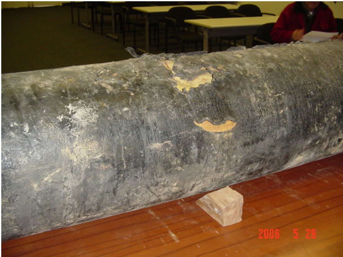
Tramo del ducto fallado, se observa el impacto recibido
