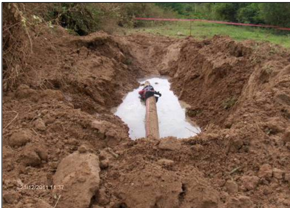
FOTO N° 02: KP 36+928, vista panorámica del forado producido por la explosión del ducto aproximadamente 14 m. de largo por 7 m. de ancho. Tapada de 1.20 m.
