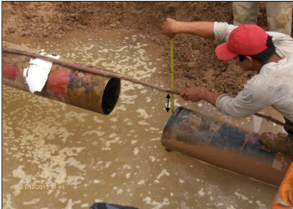
FOTO N° 04: KP 36+928, 8 pulgadas de desfase entre bordes superiores de extremos del tubo averiado. Lateralmente 3 pulgadas de desfase.
