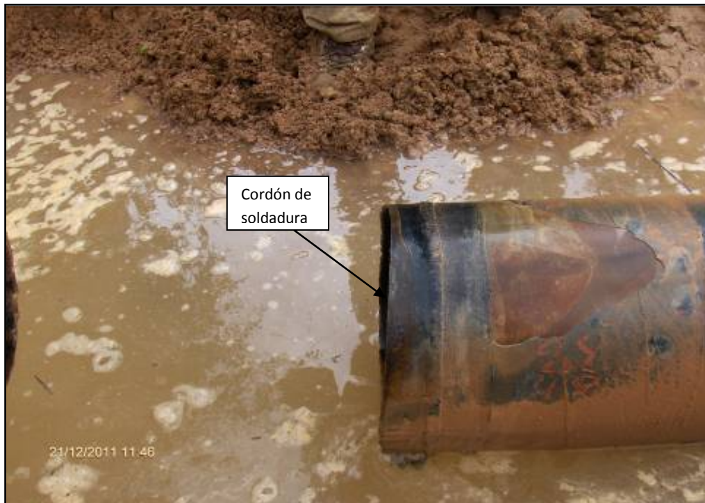
FOTO N° 05: KP 36+928, la rotura se produjo en la Zona de Afectación de Calor (ZAC) del cordón de soldadura.
