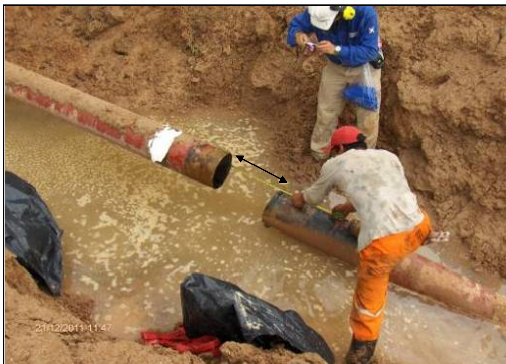
FOTO N° 03: KP 36+928, 15 pulgadas de distancia de separación entre extremos de la tubería colapsada.
