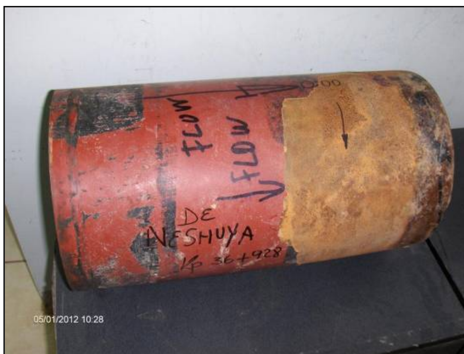
FOTO N° 09: Muestra de tubo aguas arriba de la falla (50 cm de longitud).
