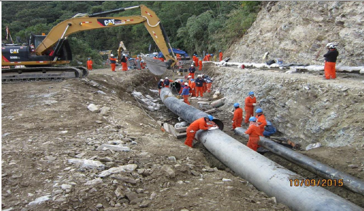
Figura 09: Vista de las secciones de los ducto de LGN y GN cortados
