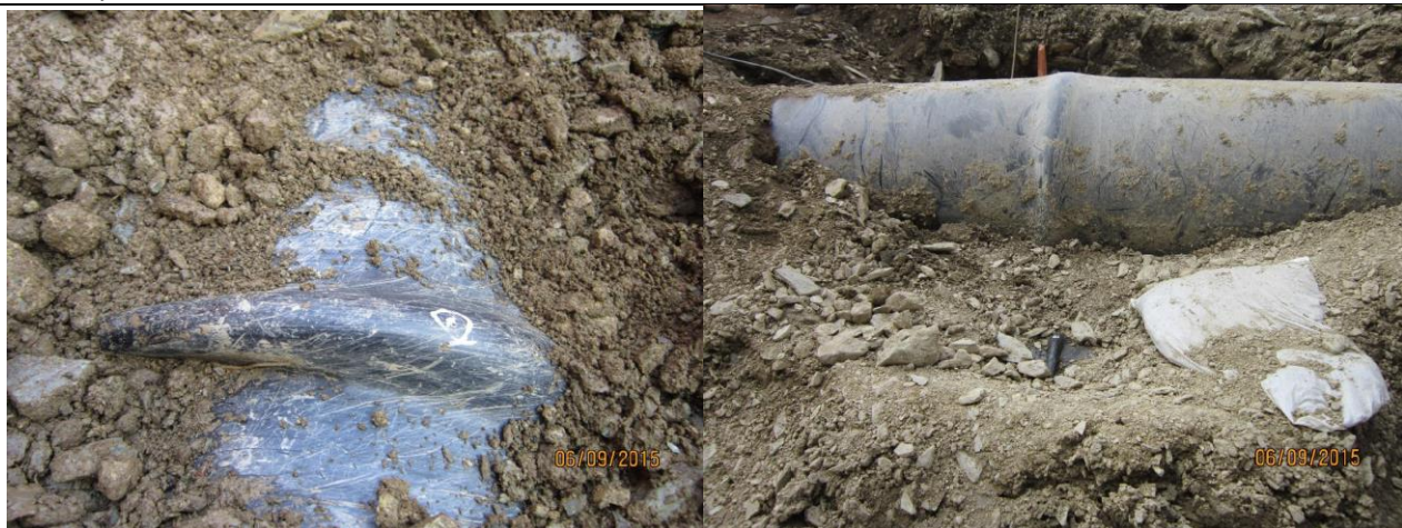
Figura 05: Vista de arrugas detectadas en los ductos de LGN (lado izquierdo) y GN (lado derecho)
