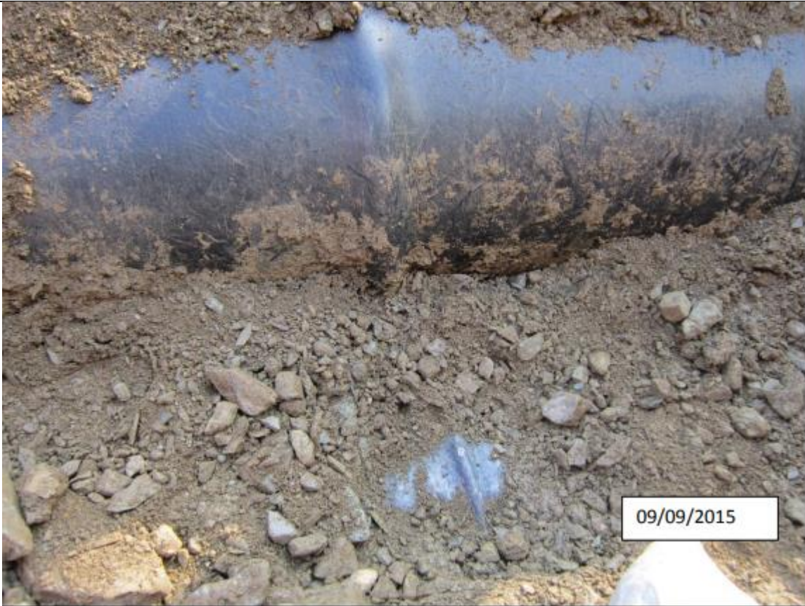
Figura 03: Vista de las anomalías detectadas en los ductos de transporte de GN y LGN.
