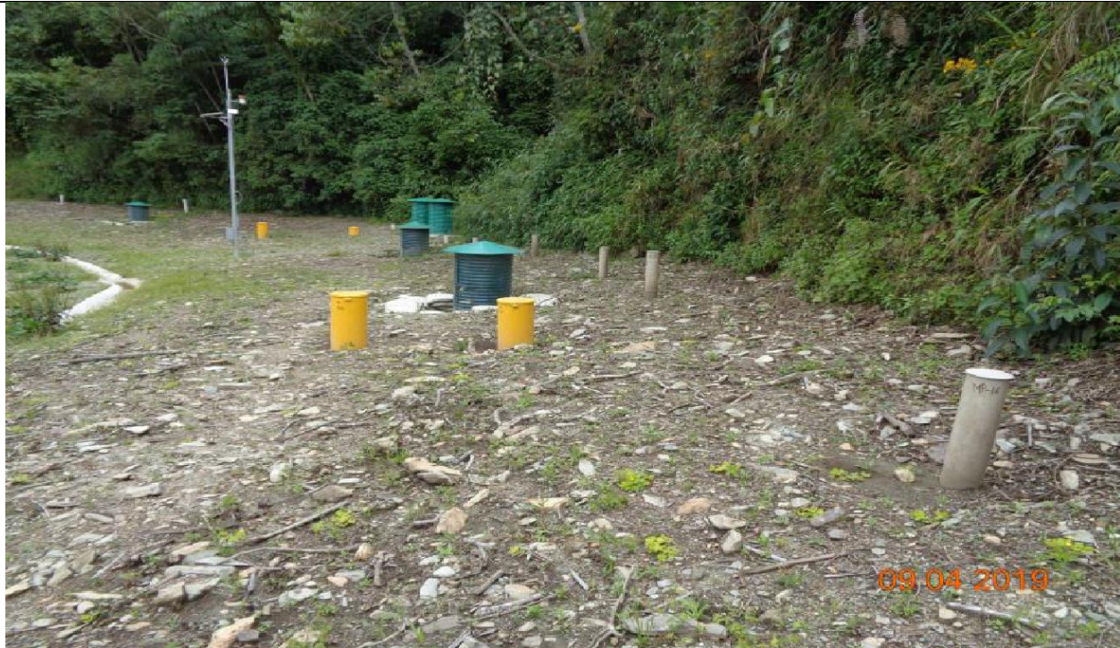
Figura 15: Vista panorámica de la instrumentación instalada a la altura del KP 196+633, inclinómetros y casetas de strain gauge.
