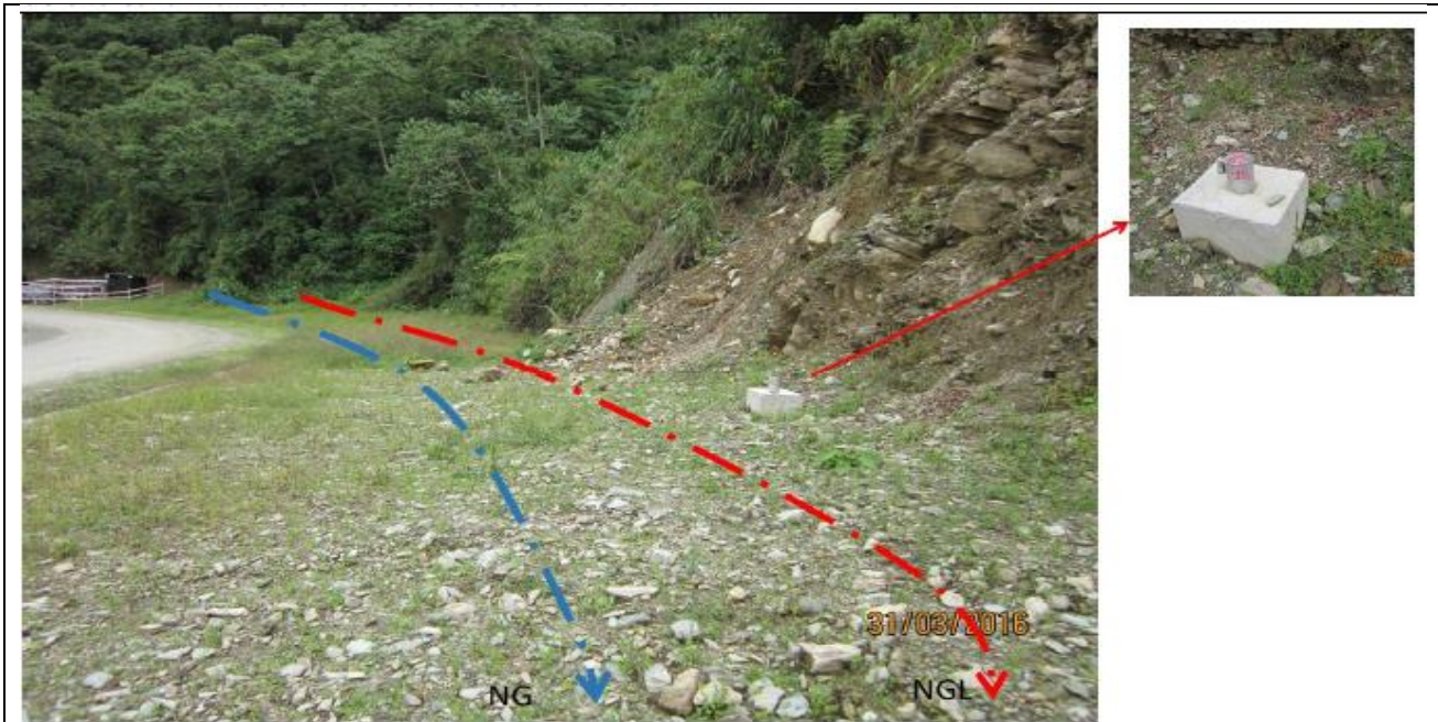
Figura 13: Vista de inclinómetro instalado a la altura del KP 196+633.
