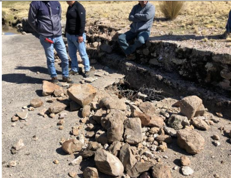
Figura 04: KP 326+570, vista de las afectaciones a los gaviones de contención cerca de cruce de camino y quebrada.
