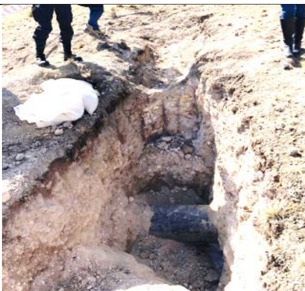
Figura 02: KP 326+570, vista de la tubería expuesta en el DDV, ocasionado por acción de terceros.
