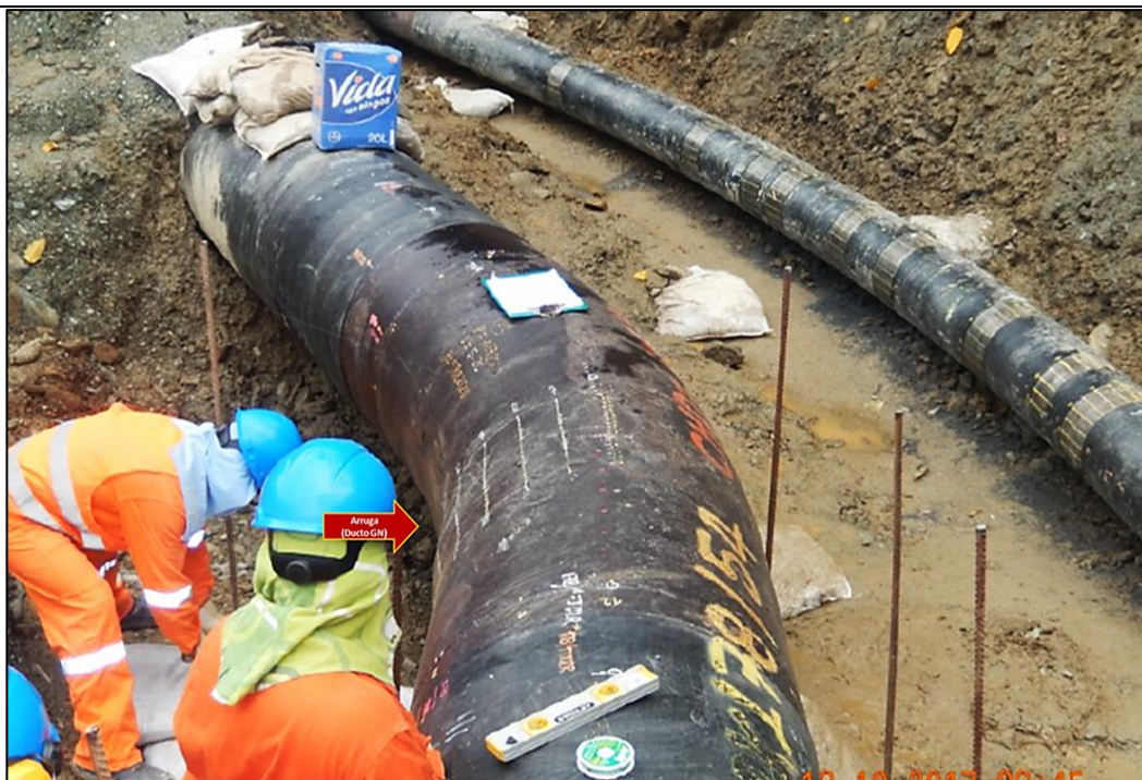
Figura 06: KP 196+581, Vista de la evaluación que realiza la empresa de las anomalías del ducto de GN.
