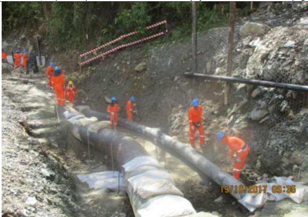
Figura 05: KP 196+581, personal de la empresa realizando trabajos de liberación de tensiones de los ductos de 34" de GN y 14" de LGN.
