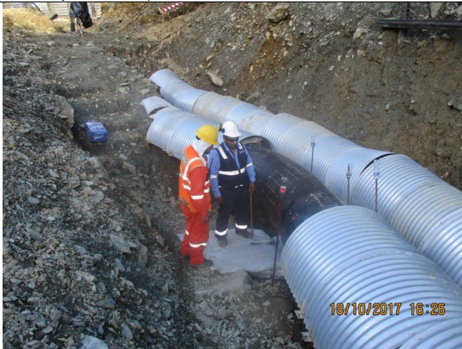
Figura 03: KP 196+581, Supervisor de Osinerghmin en la zona de la condición de riesgo reportada.
