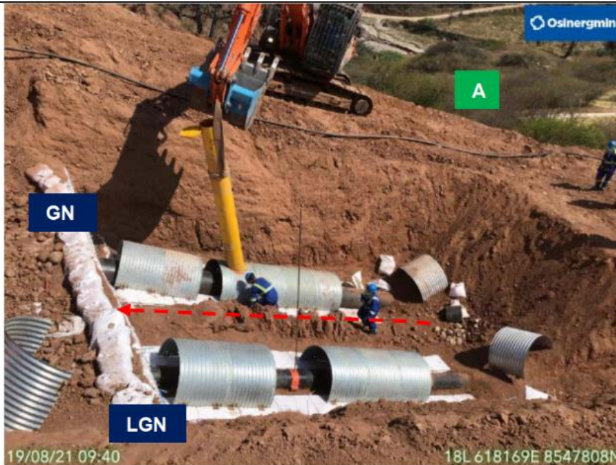
Figura 09: Ductos expuestos para la liberación de tensiones. Asimismo, se evidenció colocación de media alcantarilla sobre los ductos de LGN y GN y la instalación de una barrilla de hierro sobre el ducto de LGN para el control topográfico.
