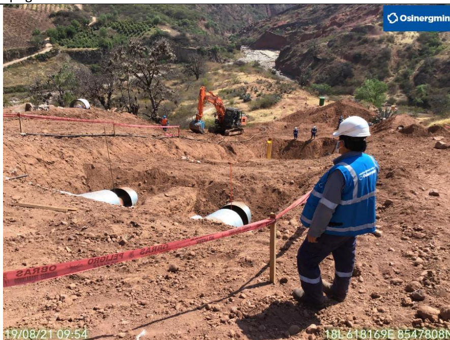
Figura 10: Vista Panorámica del DdV, con actividades de liberación de tensiones en los ductos, reducción de la cobertura de tapada y la instalación de media alcantarilla sobre los ductos de GN y LGN
