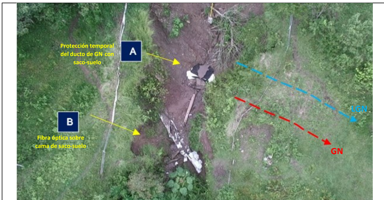
Figura 06: Vista aérea tomada con RPAS en el cruce de quebrada a la altura del KP 187+540, donde se aprecia las acciones inmediatas para proteger el ducto de gas natural
