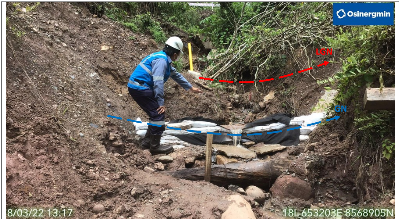
Figura 04: Vista de quebrada considerada como condición de riesgo, en el cual se aprecia la implementación de acciones inmediatas sobre el ducto de gas natural con obras temporales de saco-suelo para proteger la integridad del ducto.
