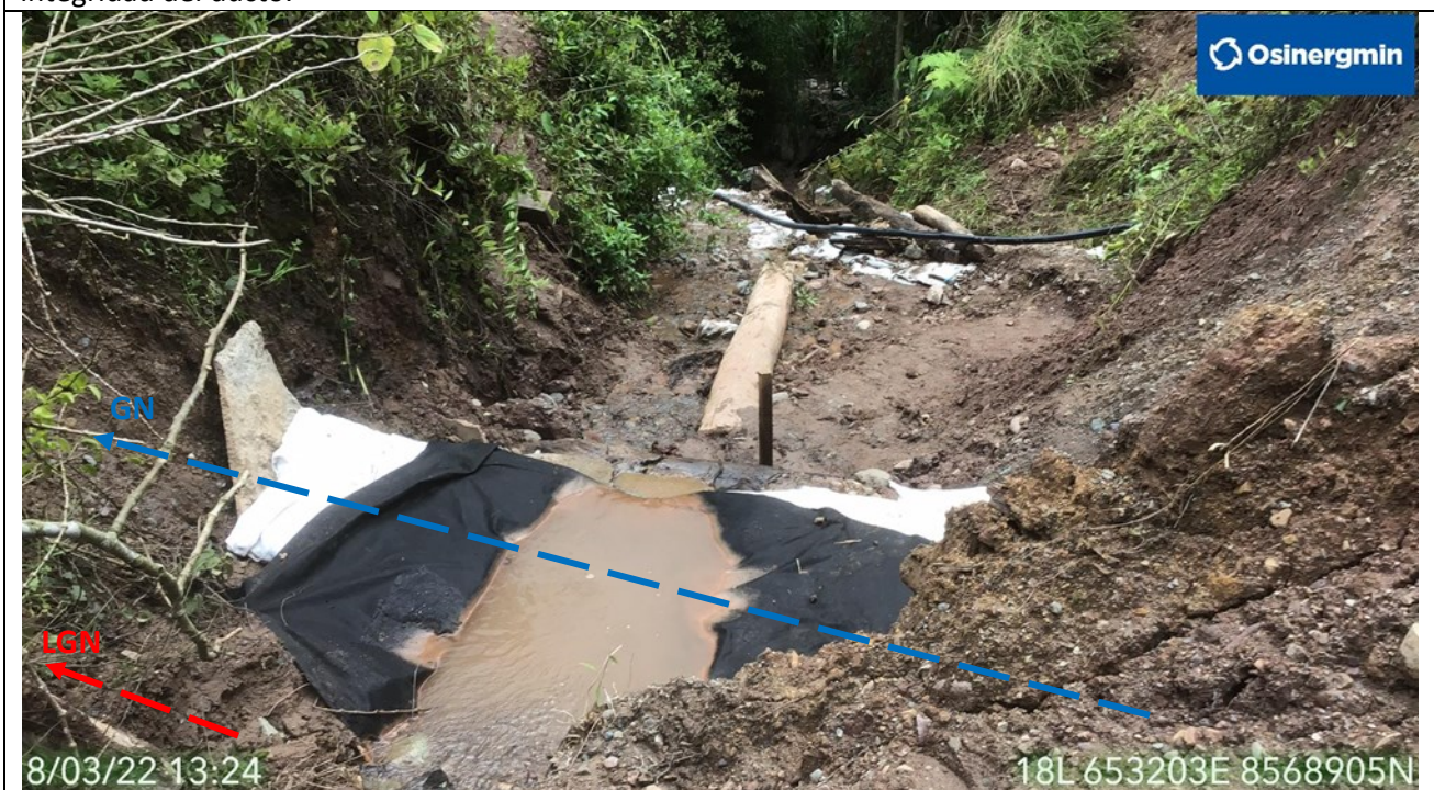
Figura 05: Vista de quebrada considerada como condición de riesgo, en el cual se aprecia las obras temporales implementadas sobre el ducto de gas natural.
