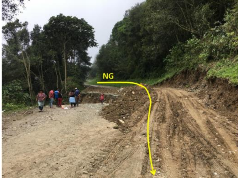
Figura 03: KP 199+800 – Vista de la habilitación de un acceso vehicular sobre el derecho de vía de los ductos sin algún tipo de evaluación técnica. Fuente TGP
