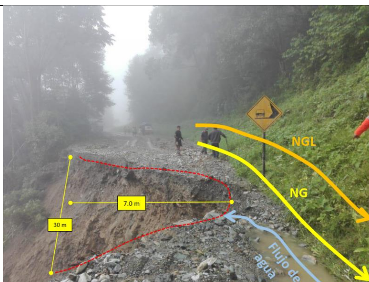
Figura 02: KP 199+800 – Vista de la pérdida de la sección de la vía San Antonio – San Miguel, producto del del flujo de detritos que ocasionó el deslizamiento en el talud inferior de la vía. Fuente TGP
