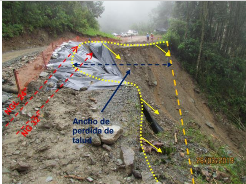
Figura 06: KP 199+800 – Talud cubierto con plástico para proteger de las lluvias y evitar mayor erosión en la corona del deslizamiento.
