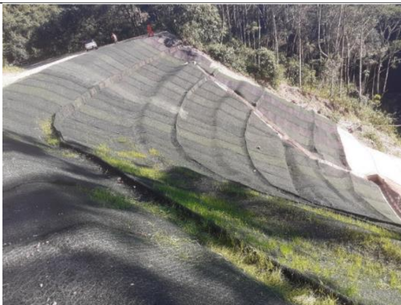
Figura 05: Trabajos culminado en el KP 199+800 donde se visualiza la reconfiguración del talud en la margen derecha del DDV revestido con malla y trabajos de revegetación. Fuente: TGP
