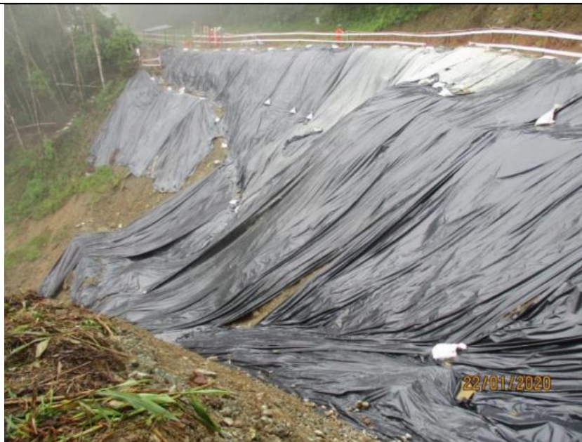
Figura 07: KP 199+800 – Verificación de la sección afectada de la vía San Antonio – San Miguel, producto del deslizamiento del talud inferior, el cual se halla cubierto con plástico agropol, para mitigar el impacto de las lluvias sobre la zona
