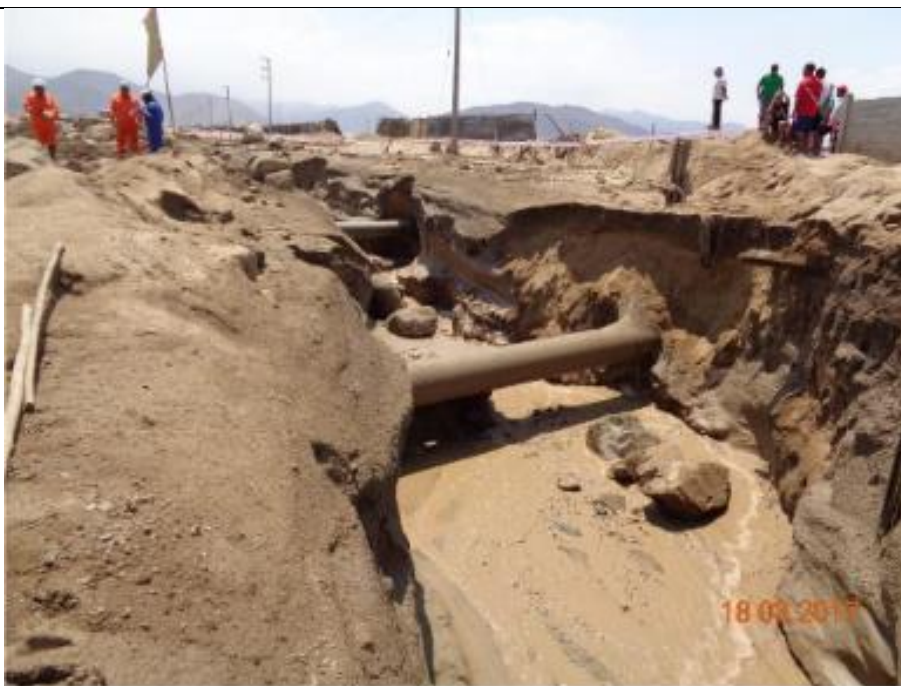
Figura 05: KP 726+140 – Verificación de la supervisión de Osinerghmin, la condición de riesgo reportada por TGP.
