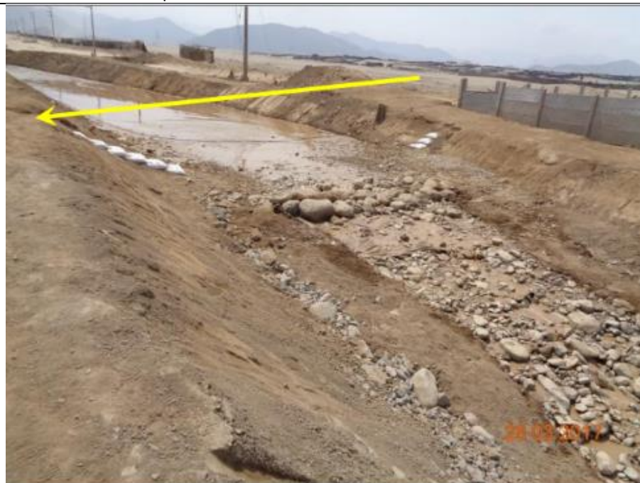
Figura 04: KP 726+140 - Vista panorámica del cruce de quebrada con los ductos de NG de 18" y de NG de 24", luego de instalado el Check Dams y conformado de la sección de encauzamiento.
