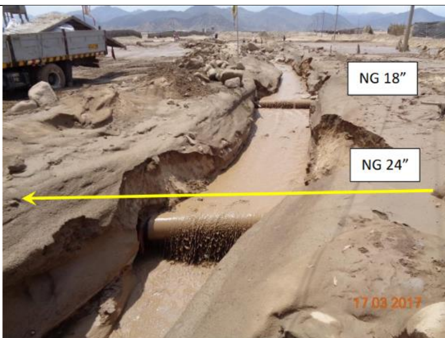
Figura 02: KP 726+140 - Vista panorámica de la quebrada Río Seco, donde se aprecian los ductos expuestos de NG de 18" y de 24".
