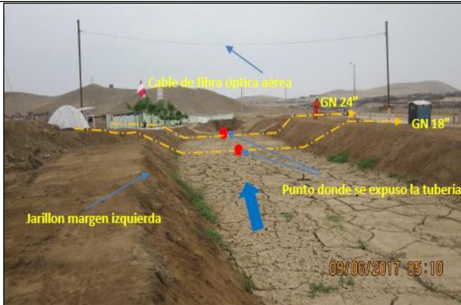
Figura 06: KP 726+140, cruce subfluvial de los ductos de 18" y 24" GN. Se verificó la ejecución de obras de construcción de jarillones en ambos márgenes del cruce.
