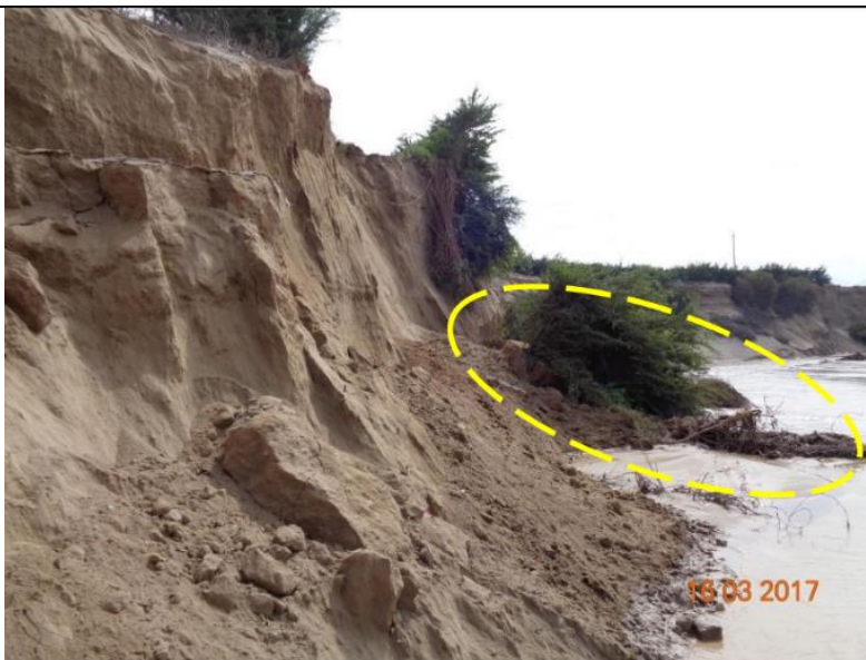
Figura 02: KP 703+940 – Supervisión de la margen derecha del cruce subfluvial donde se presentó la exposición del ducto de LGN.
