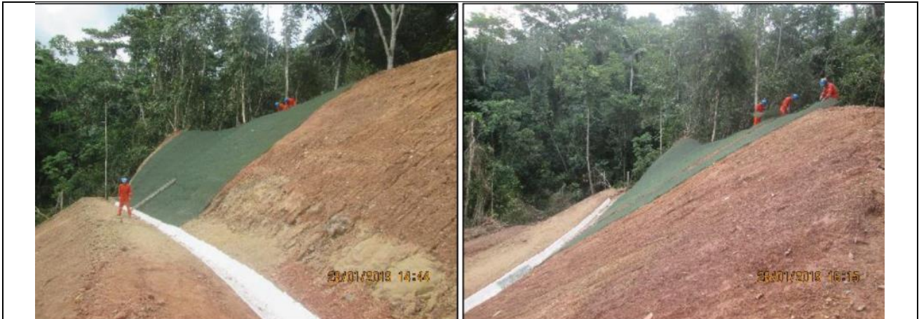
Figura 04: Trabajos de tendido de malla Macmat R en zona de escarpe donde se realizó la reconfiguración de talud en la margen derecha del DDV. Fuente: TGP
