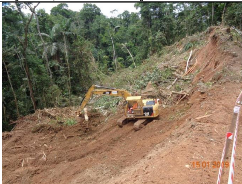
Figura 05: KP 008+400, exterior del lado derecho del DdV, se aprecia los trabajos de limpieza de vegetación y conformación de terraplén. Se aprecia la magnitud y longitud del escarpe (grieta 4) que se desarrolla próximo al DdV
