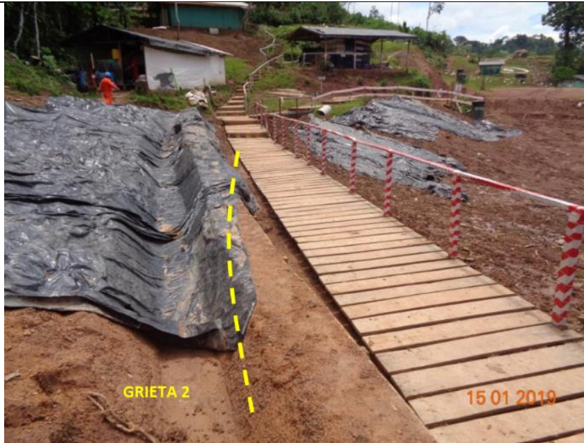
Figura 06: KP 008+400, lado izquierdo del DdV, se aprecia la zona donde se ubicaba la grieta 2 de aproximadamente 15m, en la cual se realizó el sellado de la misma
