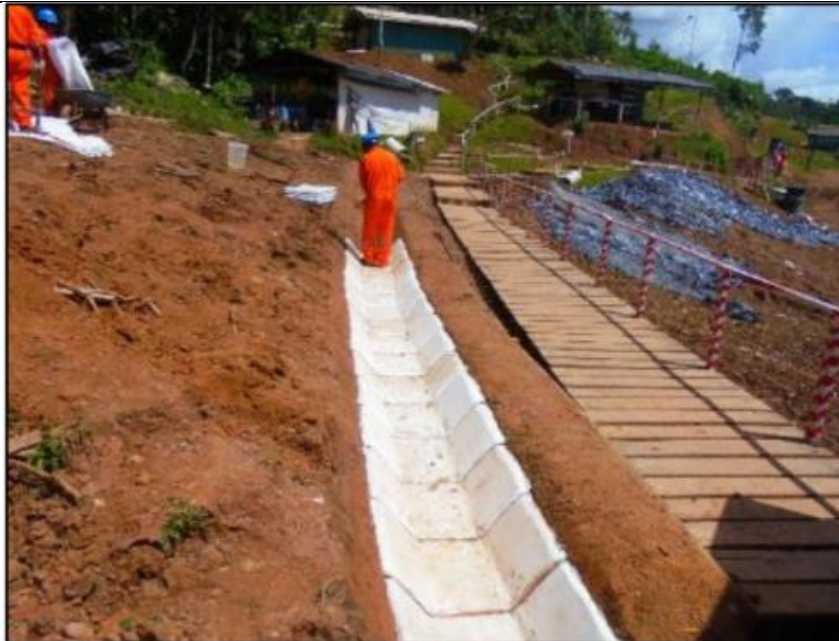
Figura 03: Vista de los trabajos de construcción de obras para el control de agua superficial sobre el DDV y margen derecha del DDV. Fuente: TGP
