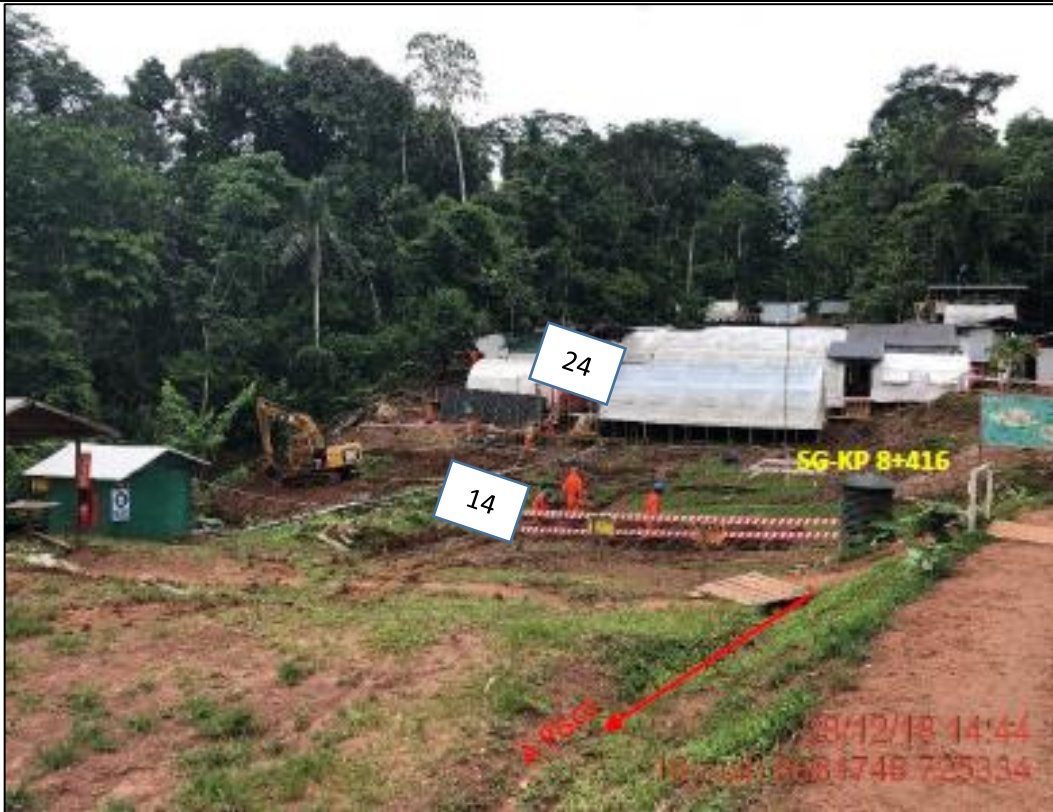
Figura 04: KP 008+400, demarcación de la zona de grietas y de los trabajos preliminares en el DDV para el sellado de grietas e implementación de obras de geotecnia.
