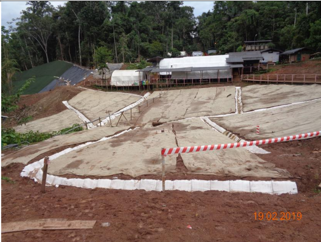
Figura 12: KP-8+400 del DDV de TGP / (WGS84, 18L 725333E 8681766N). Vista panorámica del DDV, zona de campamento temporal donde se presentaron grietas reportadas por la empresa como zona de riesgo. (fuente IS-0001003292-CEG-JAB)
