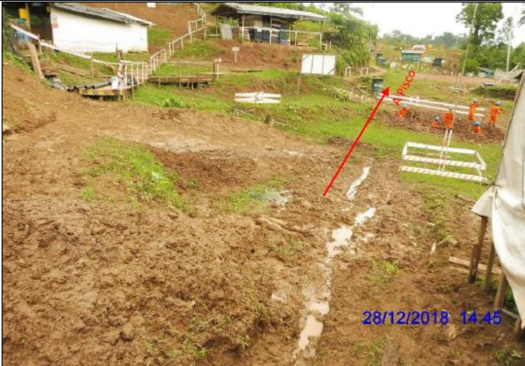
Figura 06: KP 008+400, suelos conformados por limos y arcillas, que evidenciaron saturación por la presencia de ojos de agua. El DDV pasa por una media ladera suave en esta zona.
