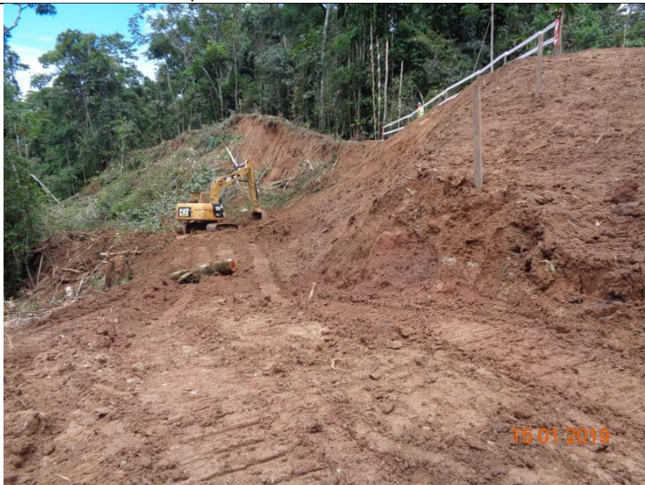
Figura 11: KP-8+400 del DDV de TGP / (WGS84, 18L 725284E 8681788N). Exterior del lado derecho del DDV, se aprecia los trabajos de limpieza de vegetación y conformación de terraplén. Se aprecia la magnitud y longitud del escarpe (grieta 4) que se desarrolla próximo al DDV (fuente IS-0001003247-CEG-JAB).
