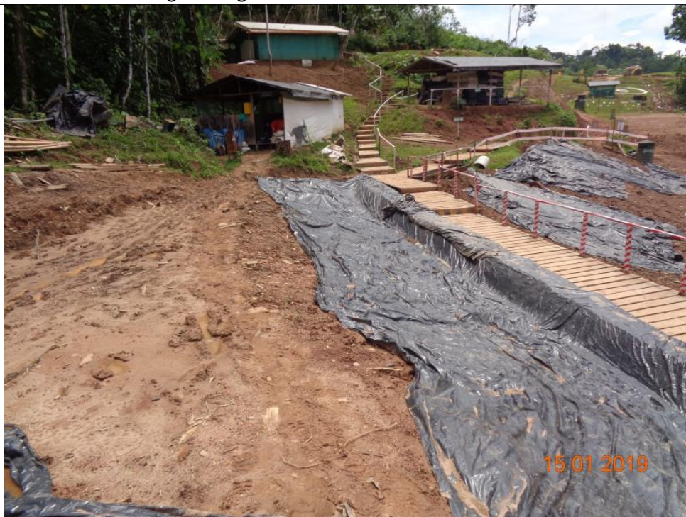
Figura 09: KP-8+400 del DDV de TGP / (WGS84, 18L 725331E 8681798N). Lado izquierdo del DDV, se aprecia la zona donde se ubicaba la grieta 1 de aproximadamente 15m, en la cual se realizó el sellado de la misma (fuente IS-0001003247-CEG-JAB)
