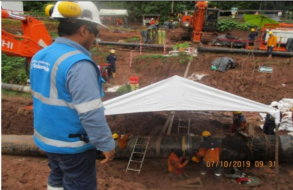
Figura 12: Se verifica el alineamiento de la tubería de 32" en la preparación de la junta 32"-8VR /J01T del KP 008+700
