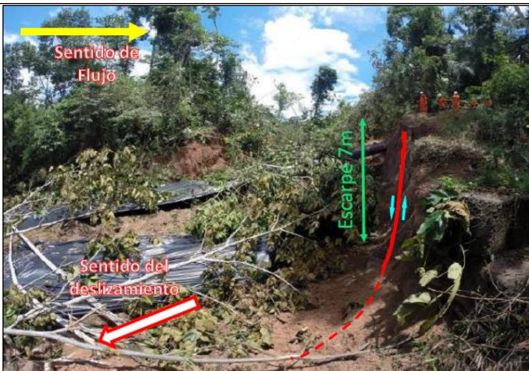
Figura 02: KP 008+900, zona donde se produjo el deslizamiento.
