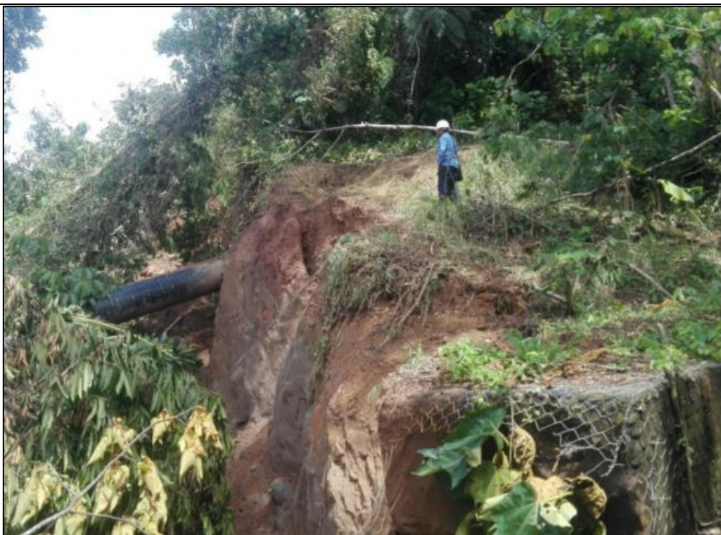
Figura 07: KP 008+900, altura de 7.00 m aprox. de altura del escarpe del deslizamiento. La tubería de 32" GN quedó expuesta.
