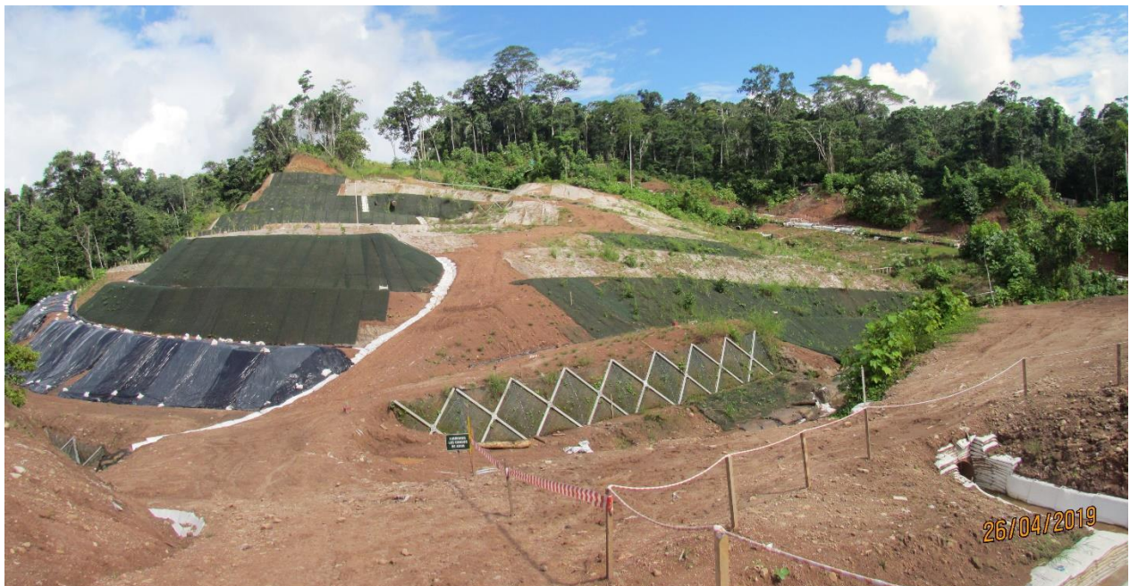
Figura 13: KP-8+900, vista panorámica de los trabajos de Geotécnica definitiva realizada en la zona.
