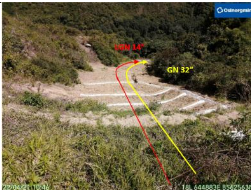
Figura 06: KP 202+099, vista del DDV en dirección a la Planta Compresora de Chiquintirca donde se verifica las obras culminadas de remediación geotécnica.
