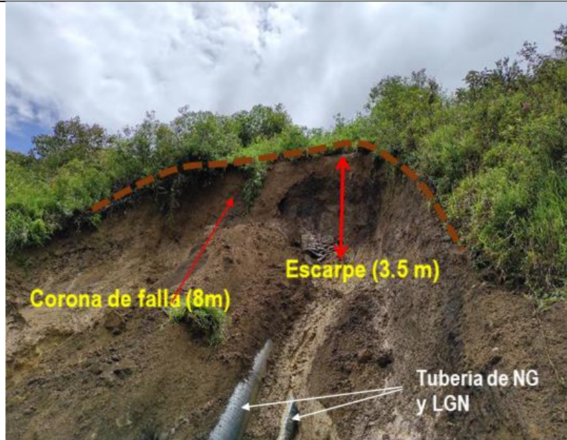
Figura 02: Vista panorámica del deslizamiento ocurrido en el DDV ocasionando la exposición de los ductos de LGN y GN en una longitud aproximada de 3.5 y 4.5 metros respectivamente. Fuente: TGP
