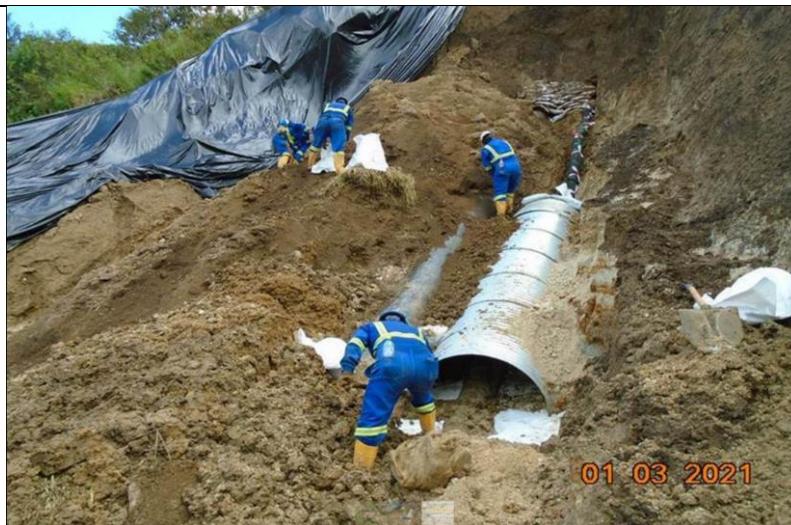
Figura 03: Actividades de manejo de agua subsuperficial, instalación de filtro geodren e instalación de alcantarilla. Fuente: TGP
