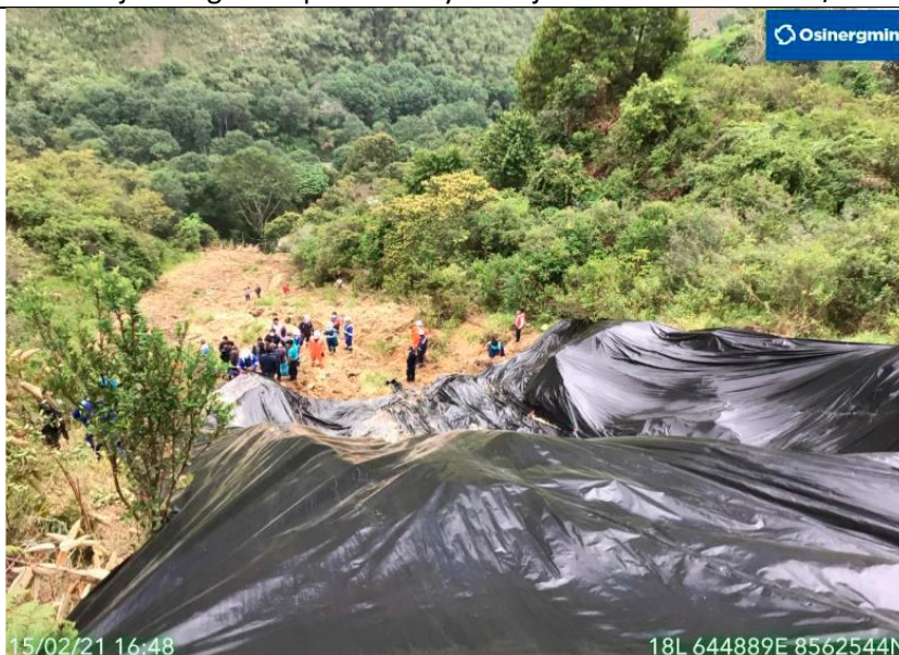
Figura 05: Verificación de la zona afectada en el KP-202+099, donde se originó el flujo de tierra el cual se halla cubierta con plástico agropol para reducir la infiltración de las lluvias al talud.
