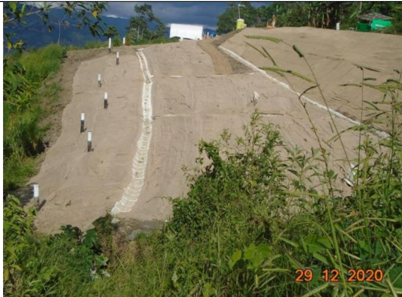
Figura 05: Trabajos de reconformación del DDV, revegetación en el área de pilotaje, instalación de yute sobre el DDV y talud, y construcción de canales colectores, cortacorrientes y pozas disipadoras. Fuente: COG001GAGEIT0219 - Informe de Integridad KP 184+000 enero 2021
