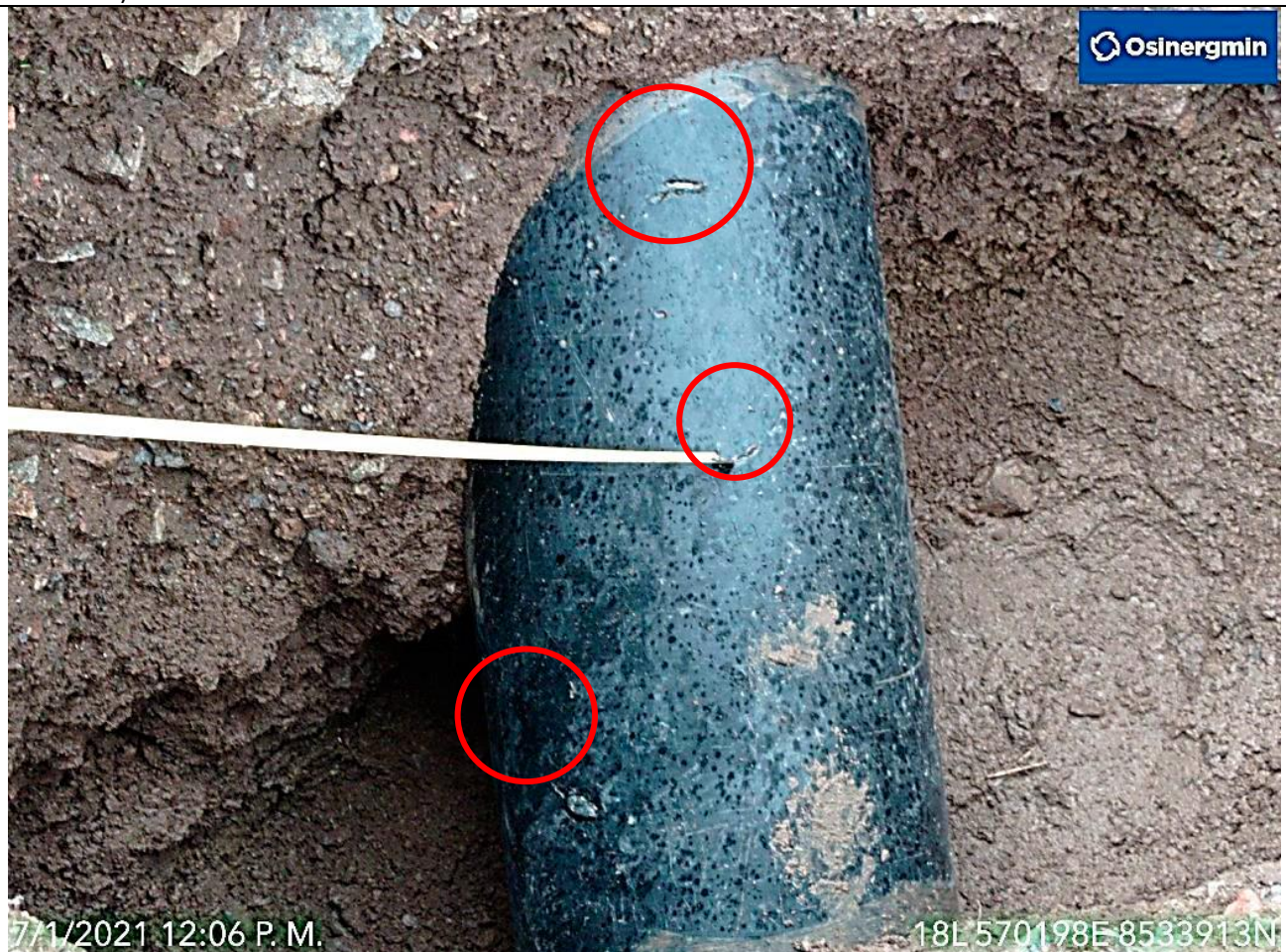
Figura 02: KP 314+020: Inspección del ducto LGN donde se aprecian múltiples daños al revestimiento del ducto.
