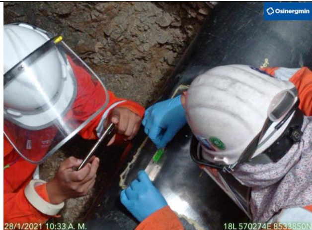
Figura 09: Caracterización de las indicaciones en el ducto de LGN
