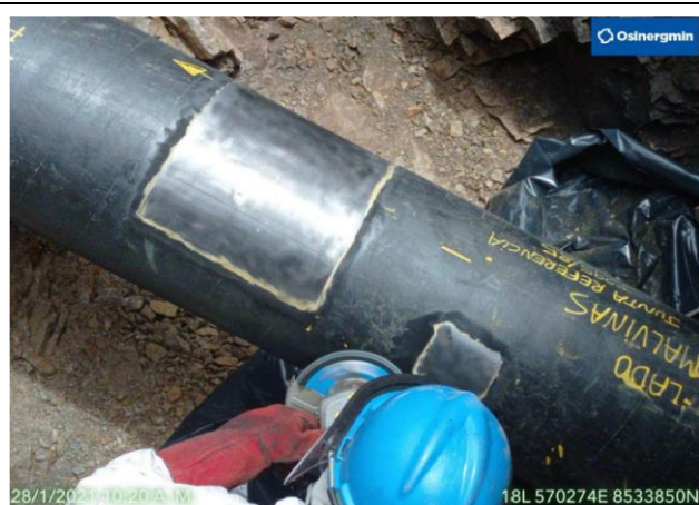
Figura 08: Retiro del recubrimiento en las zonas donde se aprecian afectaciones
