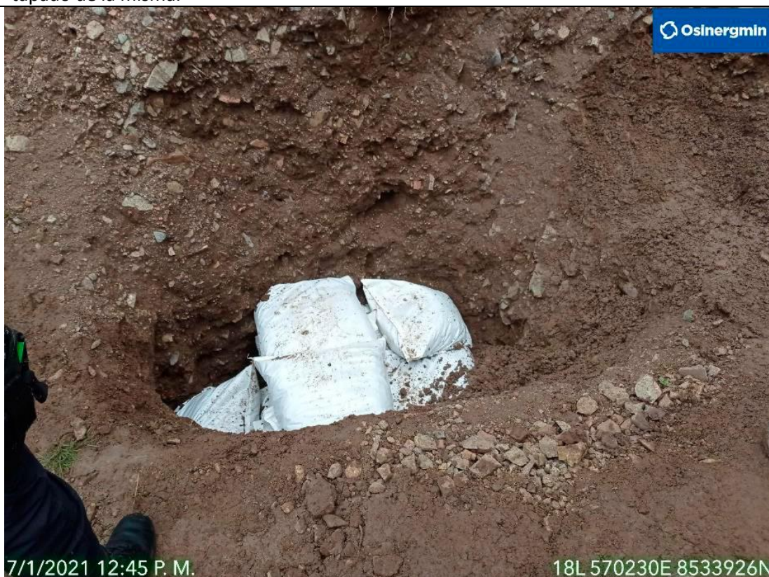
Figura 03: KP 314+020: Tapado temporal del ducto LGN con saco suelo, para protección de este, hasta la ejecución de la reparación definitiva.
