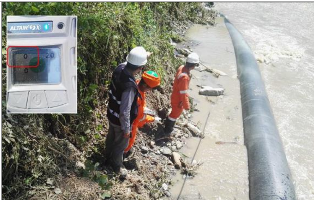
Figura 06: KP 091+521, medición de explosividad en la atmosfera cerca del ducto de GN, registrando Cero (0) LEL. Descartando la existencia de fugas de GN en el área.
