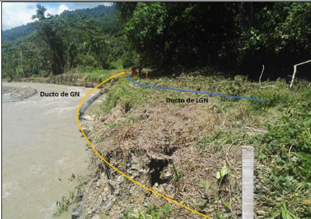
Figura 03: KP 091+521, vista general de la dirección de los ductos de GN y LGN, se aprecia que el tramo afectado corresponde a una zona de cambio de dirección.
