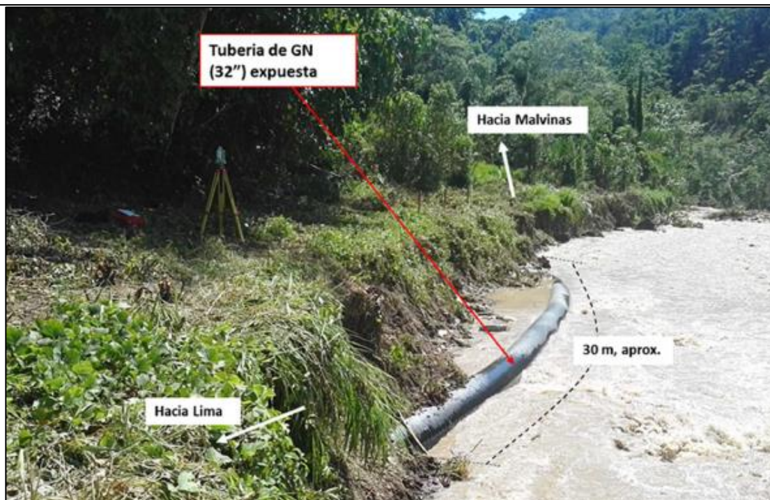
Figura 02: KP 091+521, vista general de la tubería de GN de 32", expuesta en una longitud aproximada de 30m.
