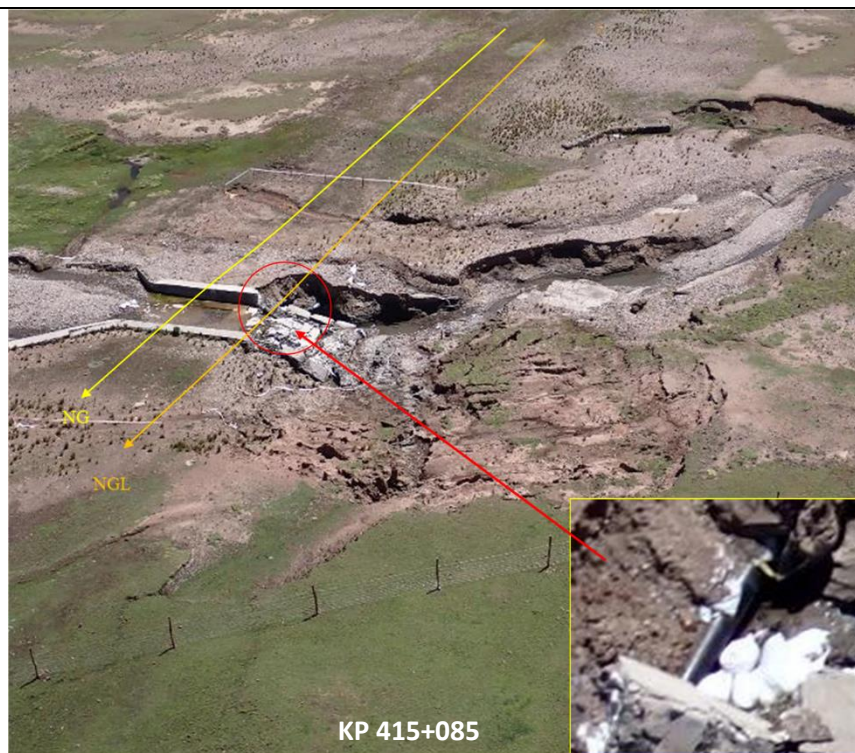
Figura 02: KP 415+085, vista panorámica de la quebrada Accopampa donde se identificó la socavación y exposición del ducto de LGN. Fuente: TGP
