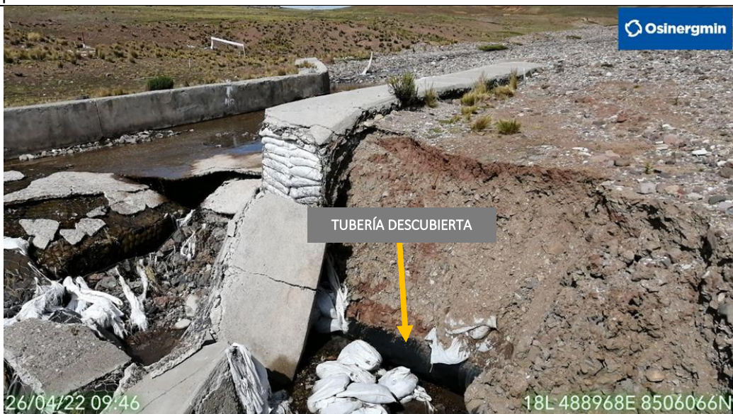
Figura 05: KP 415+085, Margen izquierda del DDV, donde se visualiza colapso de la quebrada producto de la socavación del terreno, se verifica tubería de LGN expuesta.
