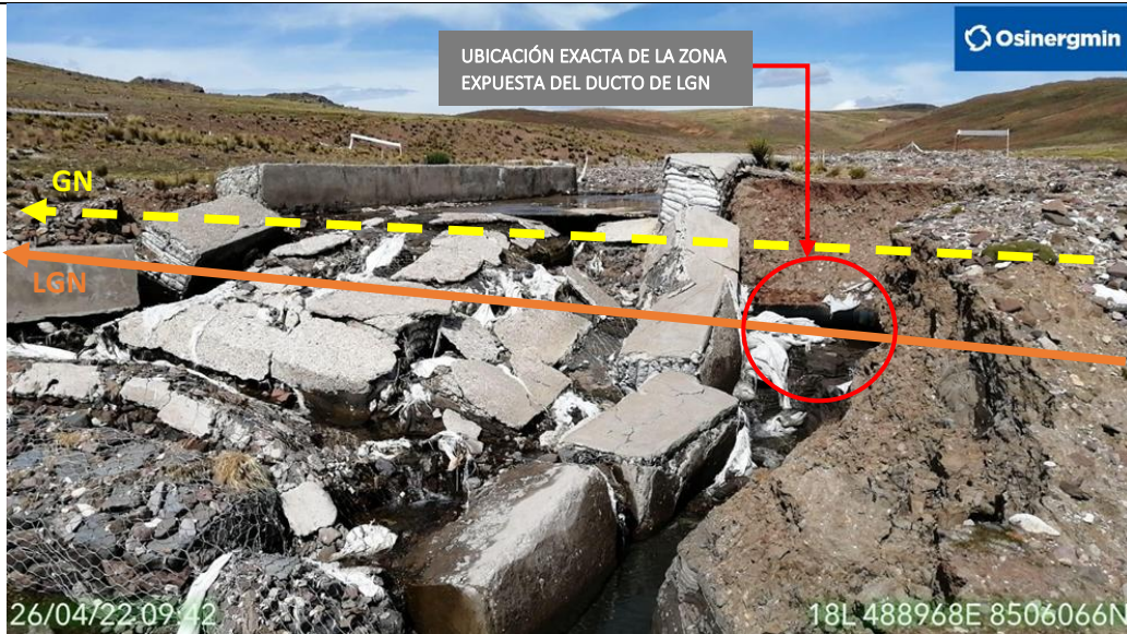
Figura 04: KP 415+085, Verificación de colapso de la descarga de la quebrada implementada con gaviones. Nótese exposición del ducto de LGN.
