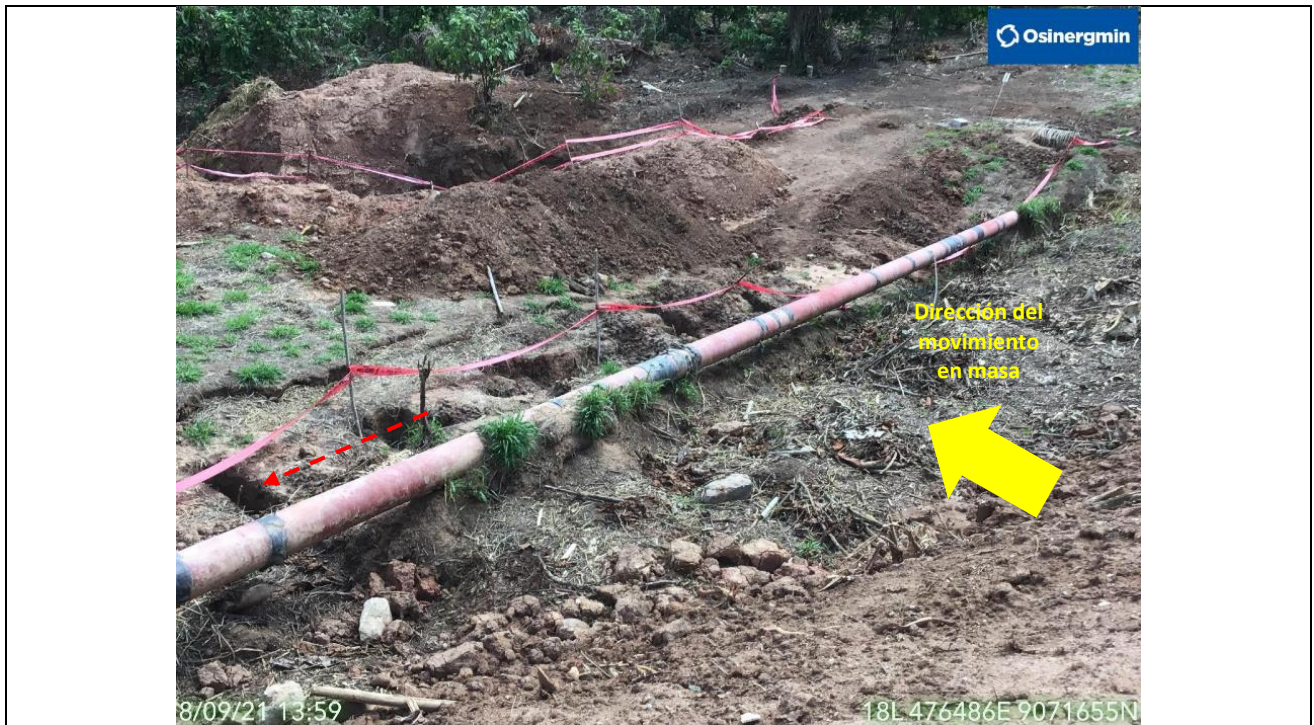
Figura 04: Ducto de GN de 12" de diámetro expuesto en una longitud aproximada de 25 metros. Asimismo se muestra la dirección del movimiento de masa.
