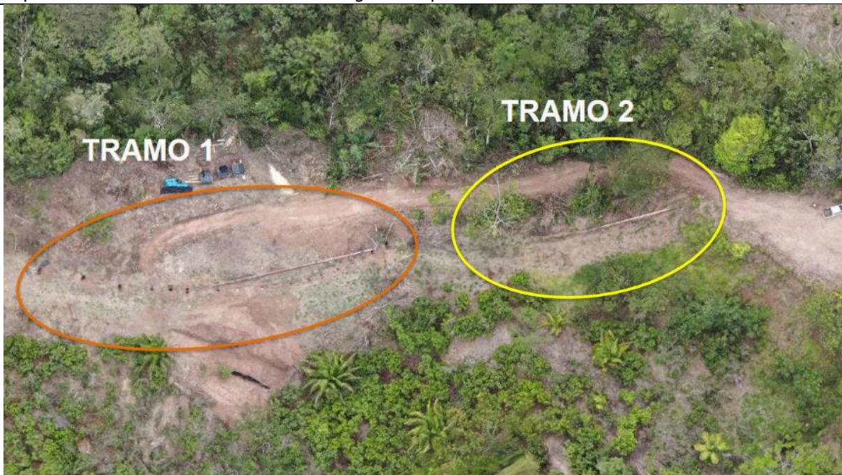
Figura 02: Vista área de la condición de riesgo a la altura de la progresiva KP 001+217 del tramo Planta de Gas – Estación Neshuya.
