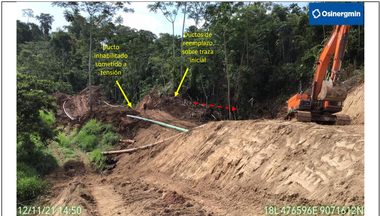
Figura 06: Vista panorámica hacia la Planta de Gas, tramo del KP 001+217 al KP 001+410, donde se realizó la reubicación y reemplazo de los ductos de 12" GN y de 4" LGN que se encontraban tensionados a causa de un movimiento en masa. Se realiza actividades de recomposición del DDV y tapado de los nuevos ductos.
