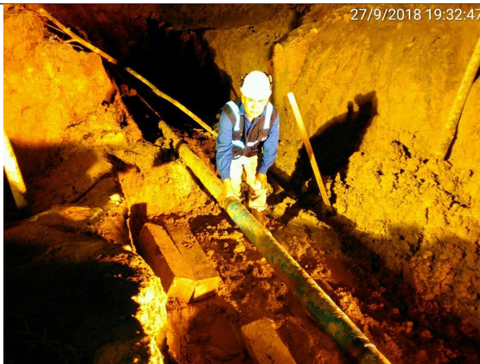
Figura 03: KP 77+800, Supervisión de Osinerghmin previo a los trabajo de corte del ducto de LGN de 4" afectado.
