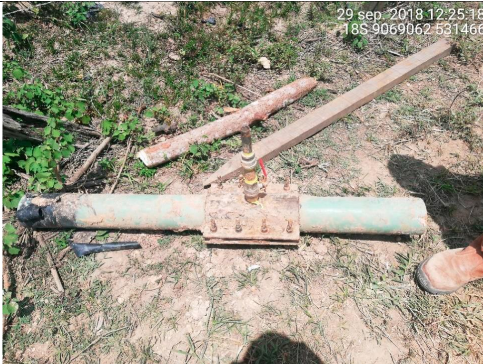
Figura 07: KP 77+800, tramo del ducto de 4" LGN reemplazado. Se puede observar con mayor detalle la grampa hechiza y el agujero de \frac{3}{4} " perforado para la extracción del LGN.
