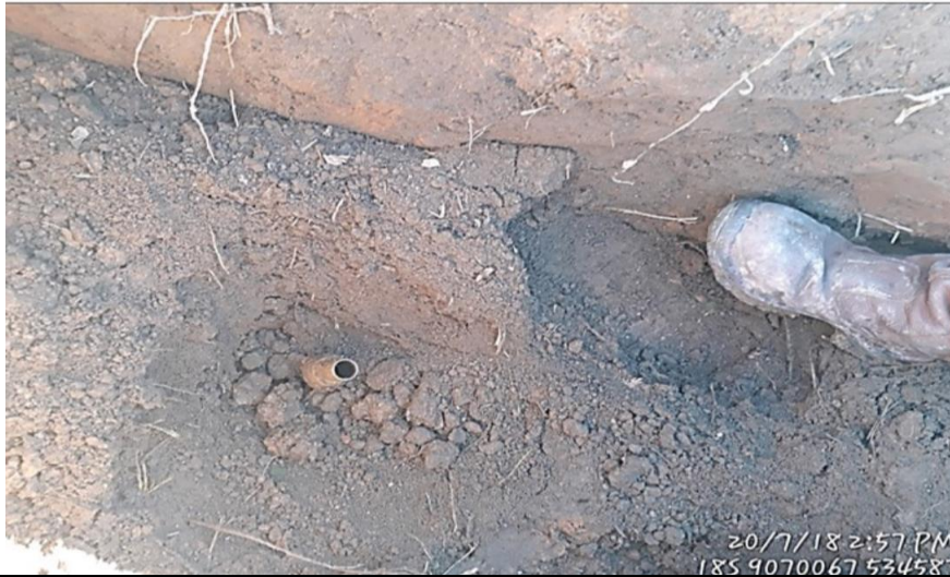
Figura 07: KP 80+850. Vista de derivación clandestina instalada en el ducto de 4" de LGN.
