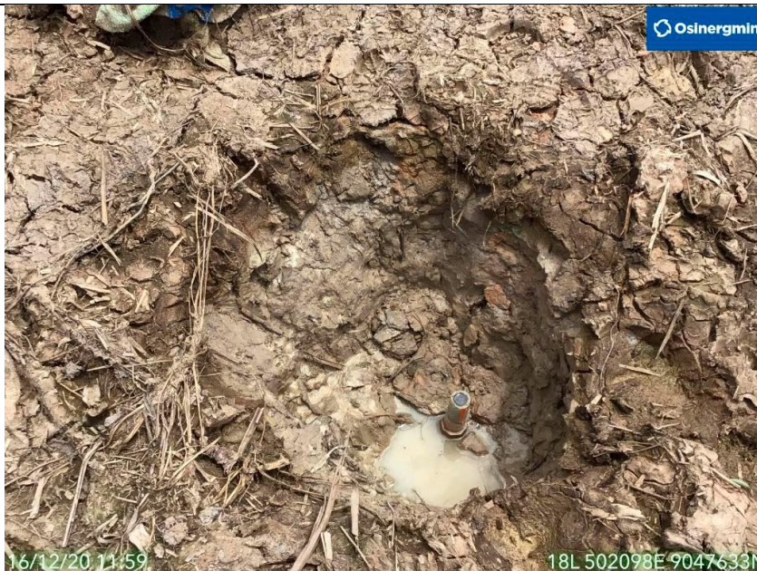
Figura 03: KP 38+250: Válvula artesanal empleada para la extracción clandestina de LGN en el ducto de 4" de AEP.
