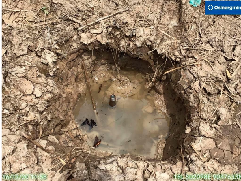
Figura 02: KP 38+250: Válvula artesanal empleada para la extracción clandestina de LGN 2 en el ducto de 4" de AEP.
