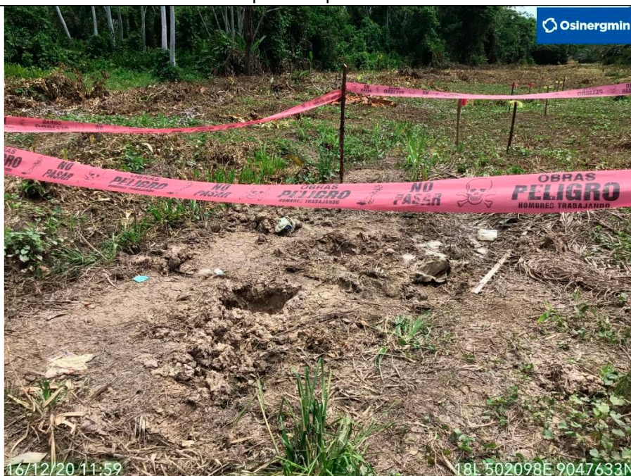
Figura 05: KP 38+250: Excavaciones realizadas en la línea del ducto de 4" que transporta LGN, con la finalidad de extraer de forma clandestina el LGN.
