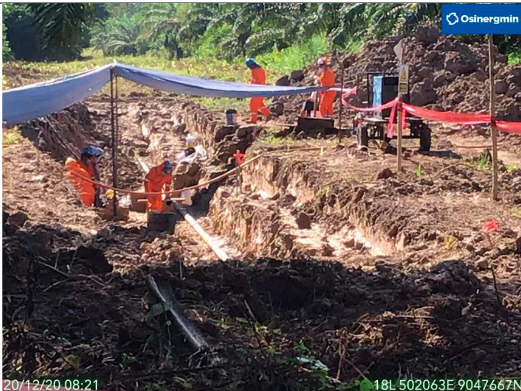
Figura 07: Vista de la zona de afectación por terceros al ducto de 4" de LGN, tramo Planta de Gas de Curimaná - Estación Neshuya. Se culminaron los trabajos de soldadura.
