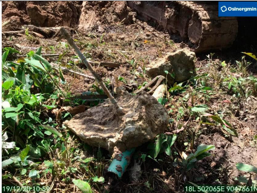
Figura 06: Vista del tramo del ducto de 4" de LGN con afectación por terceros. Se aprecian la instalación de 2 conexiones en el ducto.
