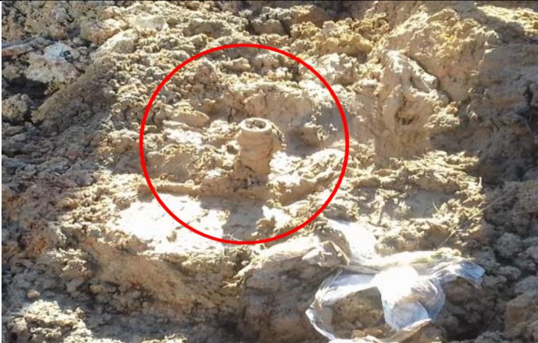
Figura 02: KP 78+400. Vista de la derivación clandestina instalada en el ducto de 4" de LGN. Fuente: Aguaytía Energy del Perú S.R.L.
