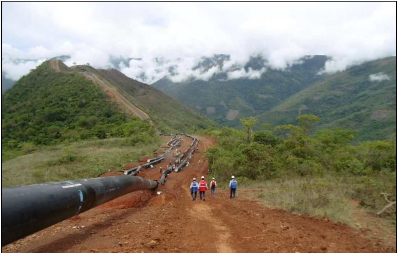
KP 130. Pista del DDV, intransitable para los vehículos debido a las lluvias
