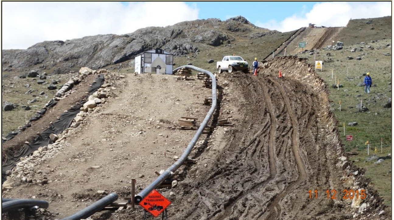
Estado del DdV de las actividades constructivas en el Gasoducto Secundario Anta-Cusco Ramal B Anta - Cusco
